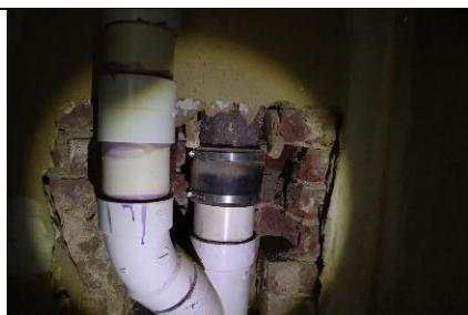
264.att. Kanalizācijas PVC un ķeta cauruļvadi
