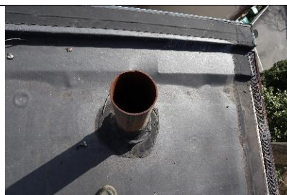
265.att. Sadzīves kanalizācijas izvads uz jumta
