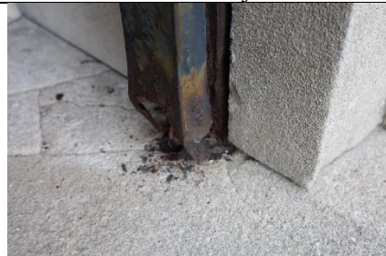
211.att. Korozija metāla vārtu rāmī
