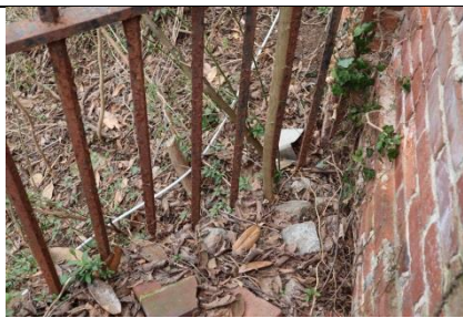
36.att. Korodējis metāla nožogojums
