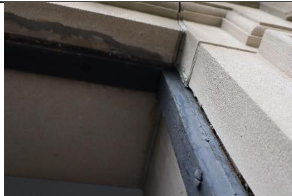
212.att. Korozija metāla vārtu rāmī
