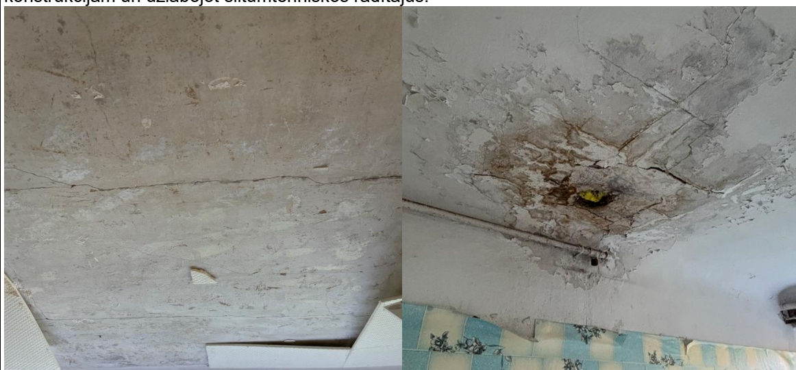
2.stāva griesti – apmetums bojāts, deformējies.
