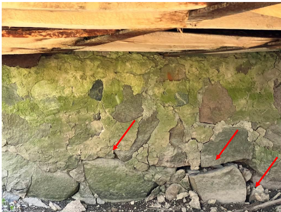
13.att. Paskalojumi un betona izdrupumi krasta balstiem. Skats uz krasta balstu Nr.2.
