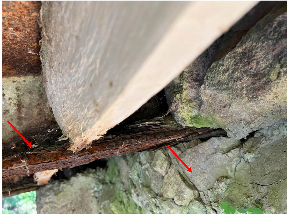
9.att. Saimnieciskā kārtā izbūvēta laiduma konstrukcija. Vecderīgas konstrukcijas, stipra korozija metāla sijām pie balsta, ūdens caur plātni tek uz tērauda sijām. Skats pie krasta balsta Nr.1.
