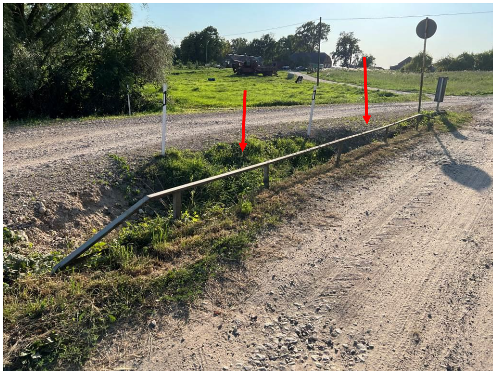
6.att. Tiltam neatbilstošas satiksmes drošībai barjeras un trūkst margas. Skats augšteces pusē.
