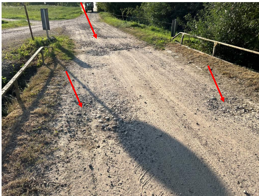
4.att. Bedres tilta segumā, sanesumi un apaugums. Picejās iesēdumi un veidojas bedres. Skats no a/c V1029 puses.
