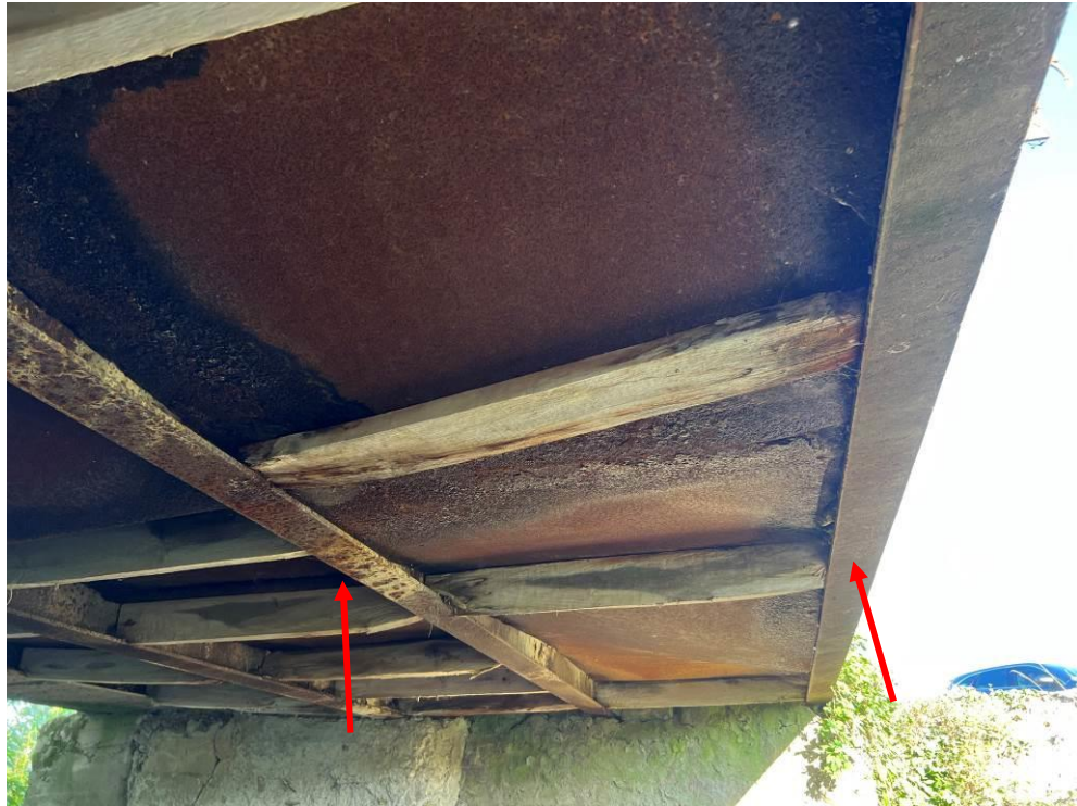
7.att. Saimnieciskā kārtā izbūvēta laiduma konstrukcija. Vecderīgas konstrukcijas, korozija metāla daļām. Skats uz laidumu no apakšas.
