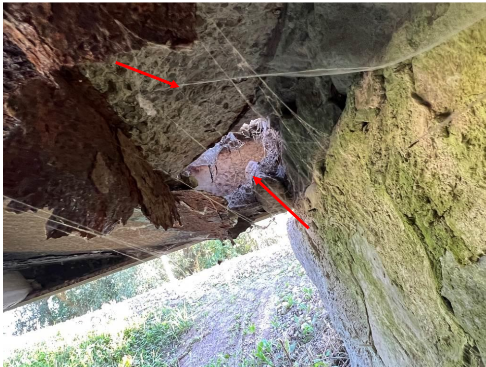
5.att. Caurums brauktuves plātnē, drūp betons, nepietiekams plātnes stiegrojums, tas korodē. Skats pie krasta balsta Nr.2 augštecē.
