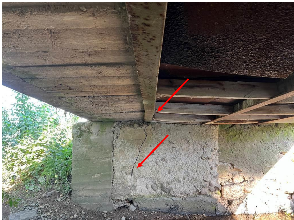
10.att. Deformējusies laiduma 2.sija no lejteces puses, plaisa balsta ķermenī. Skats pie krasta balstu Nr.1 lejtecē.
