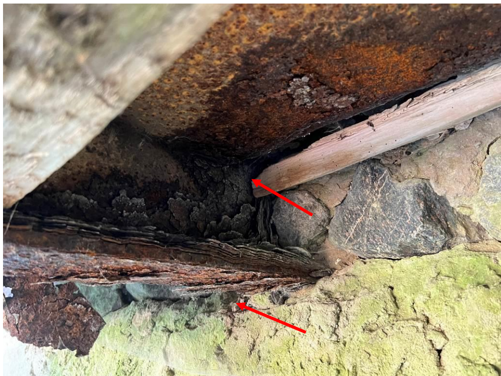
8.att. Saimnieciskā kārtā izbūvēta laiduma konstrukcija. Vecderīgas konstrukcijas, stipra korozija metāla sijām pie balsta, ūdens caur plātni tek uz tērauda sijām. Skats pie krasta balsta Nr.2.
