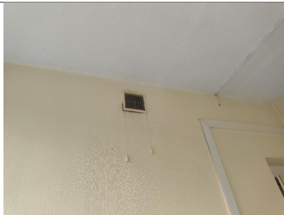
Dabīgās ventilācijas kanāli Rīgas ielā 4 ar šīberiem gaisa plūsmas regulēšanai.
