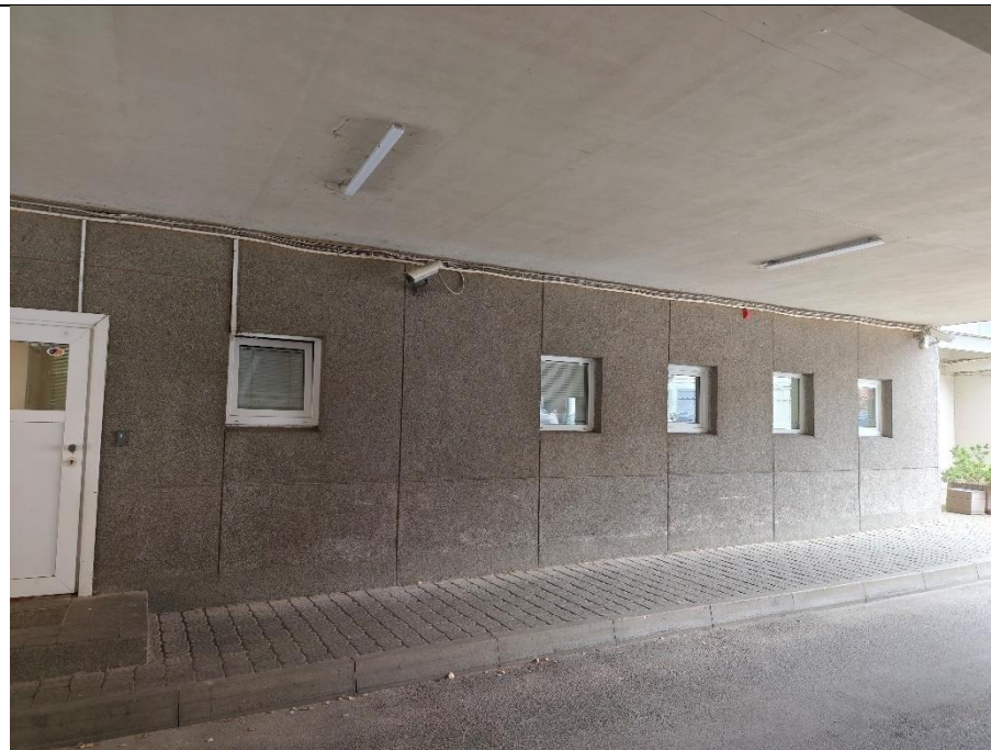
Rīgas ielas 4 Dienvidu fasāde zem iebrauktuves.
