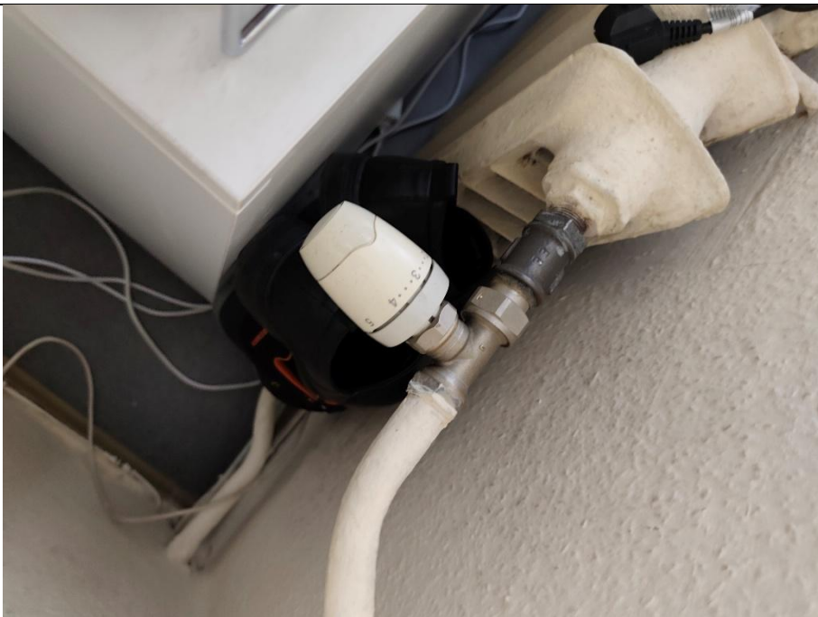
Daļai no radiatoriem uzstādīti termoregulācijas vārsti.
