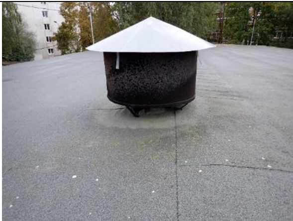
Attēls Nr.4.10.1. Ventilācijas kanāli
