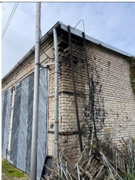
Attēls Nr.4.5.9. Ūdens un sala rezultātā, bojāts ēkas stūris
