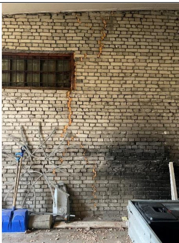
Attēls Nr.4.2.3. 1. sekcijas 1. punkts. Plaisas ēkas ārsienā.
