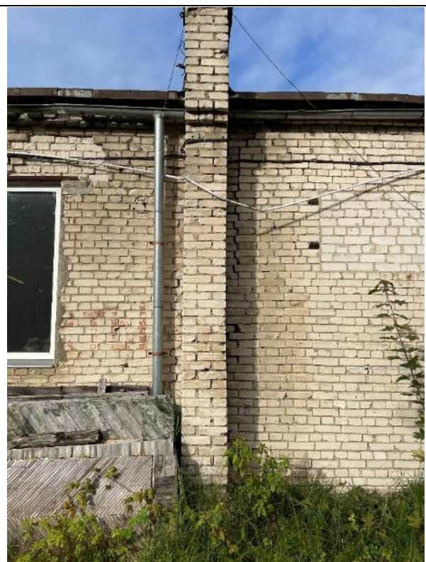
Attēls Nr.4.2.10. 5. sekcijas 3. punkts. Plaša ķieģeļu sienā.
