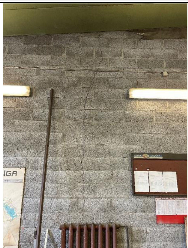
Attēls Nr.4.2.8. 5. sekcijas 1. punkts. Plaša ķieģeļu sienā.
