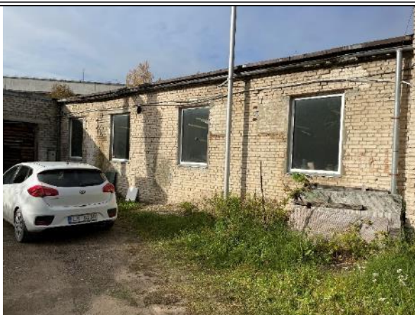
Attēls Nr.4.2.11. 5. sekcijas 4. punkts. Atslāņojusies ķieģeļu siena.
