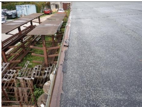
Attēls Nr.4.5.6. Juma lāseņa daļa ir augstāka par jumta plakni, veidojas pelķes.
