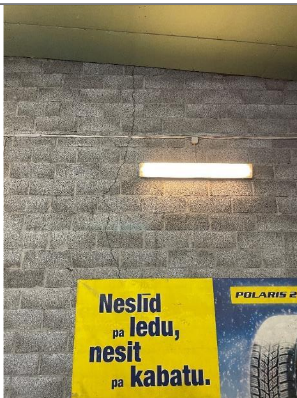
Attēls Nr.4.2.9. 5. sekcijas 2. punkts. Plaša ķieģeļu sienā.
