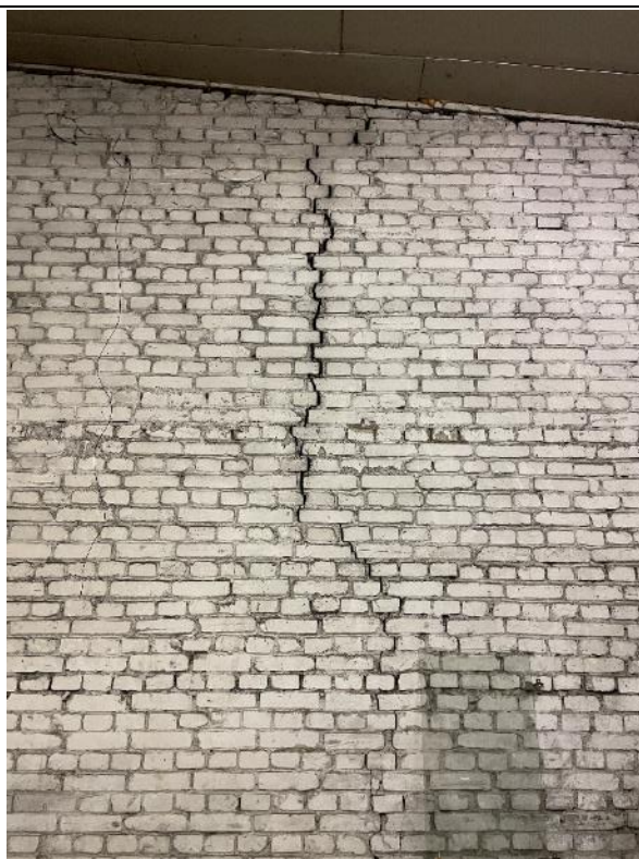
Attēls Nr.4.2.3. 1. sekcijas 1. punkts. Plaisas ēkas ārsienā.
