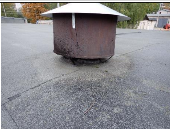
Attēls Nr.4.9.1. Ventilācijas kanāli
