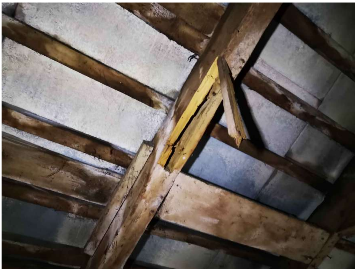
33.fotoattēls Lokāli zuduši jumta konstrukcijas elementi.
