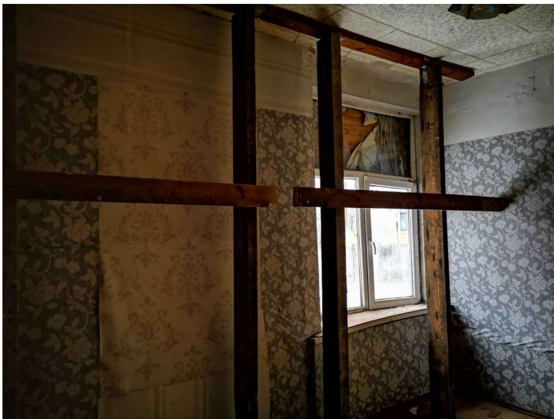
17.fotoattēls Lokāli pārbalstīts 1.stāva pārseguma posms.
