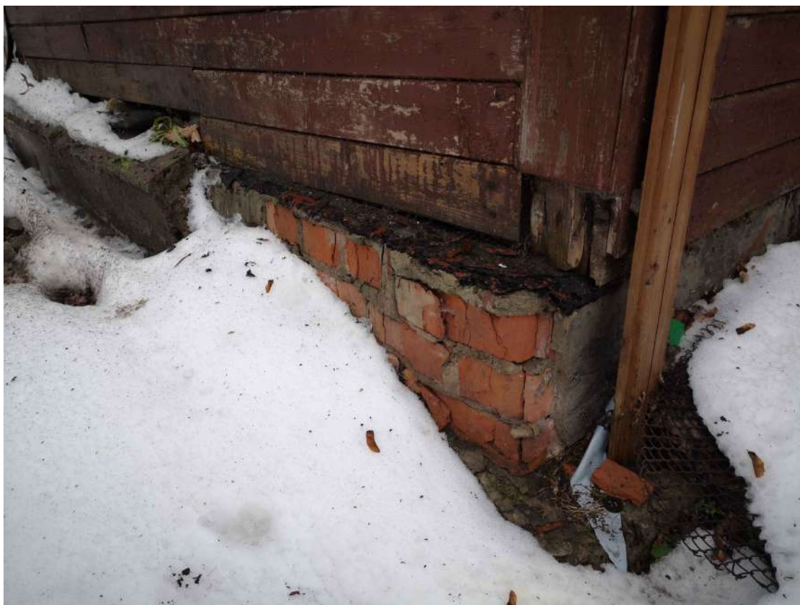
53.fotoattēls Erodējuši piebūves virspamati.
