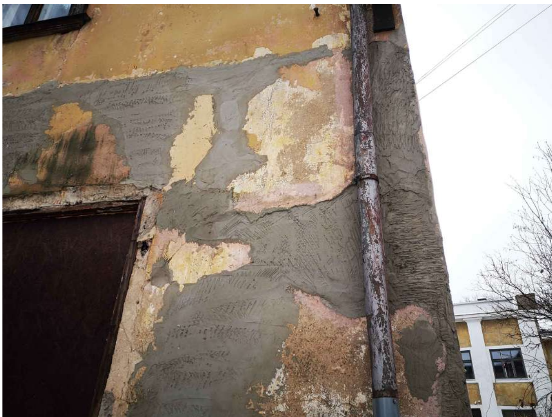
51.fotoattēls Sekundāri fasādes apdares labojumi ar cementa javu.
