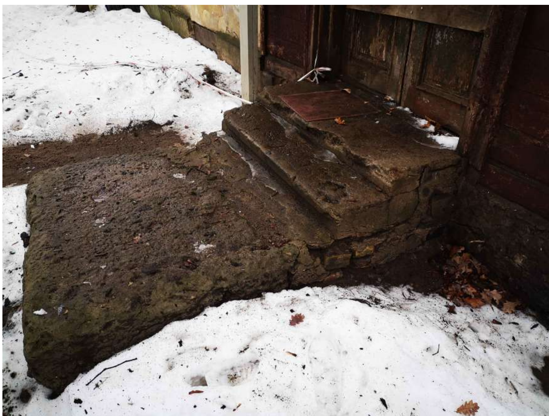
54.fotoattēls Erodējušas piebūves lieveņa konstrukcijas.
