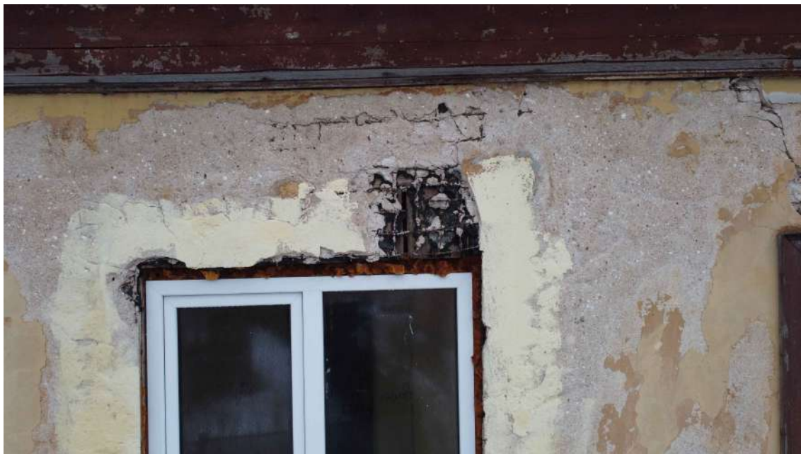
5.fotoattēls Fasādes apmetuma un metāla sieta bojājumi.
