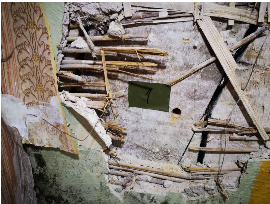
43.fotoattēls Kontrolurbumi 2.stāva Z puses ārsienas konstrukcijā.
