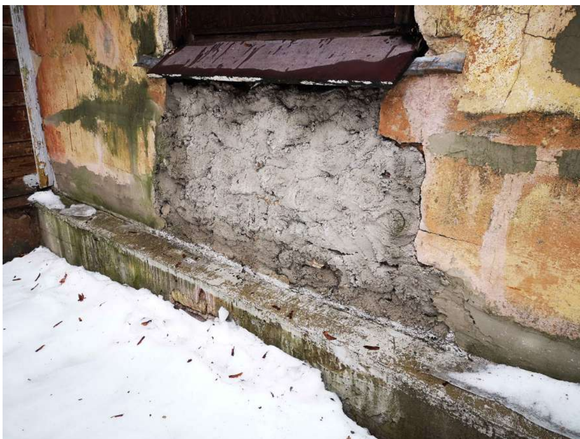
50.fotoattēls Sekundāri fasādes apdares labojumi ar cementa javu.
