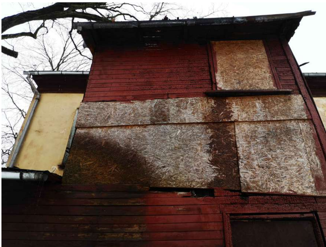
47.fotoattēls Uguns bojātas piebūves konstrukcijas.
