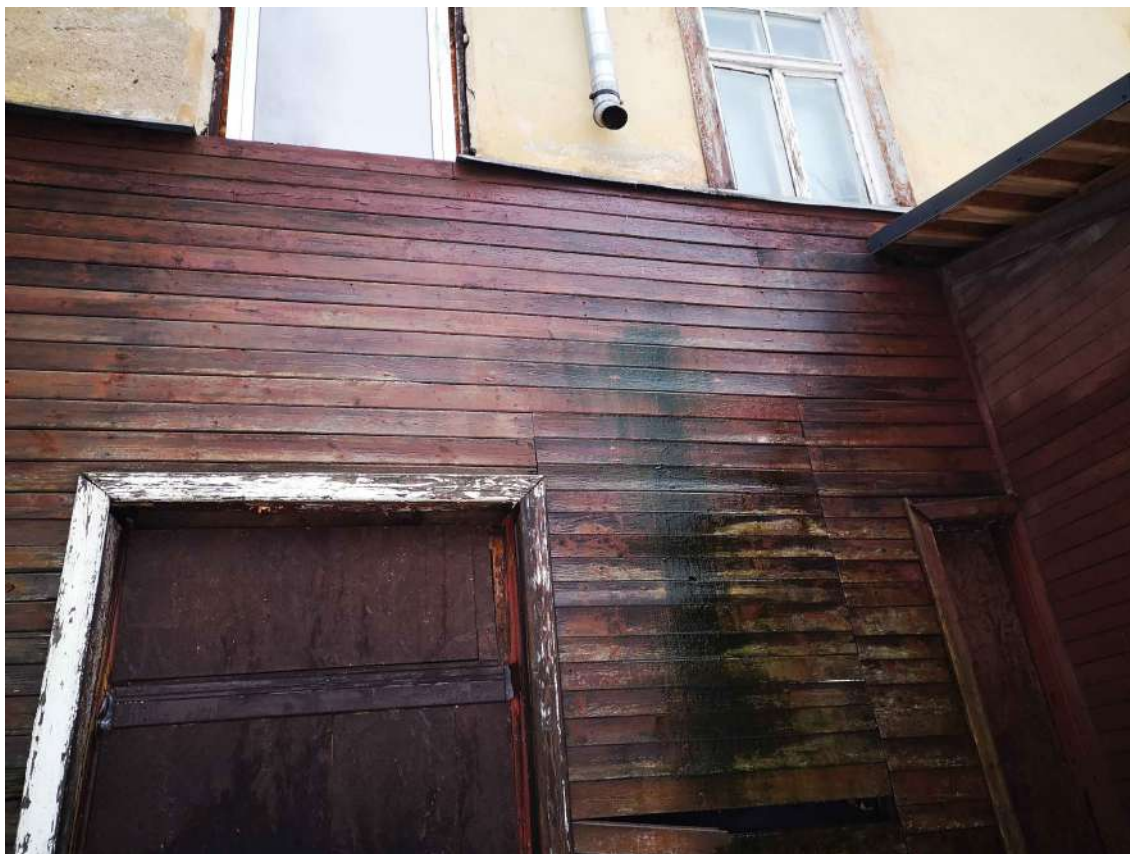
46.fotoattēls Mitruma izraisīti fasādes apdares bojājumi.
