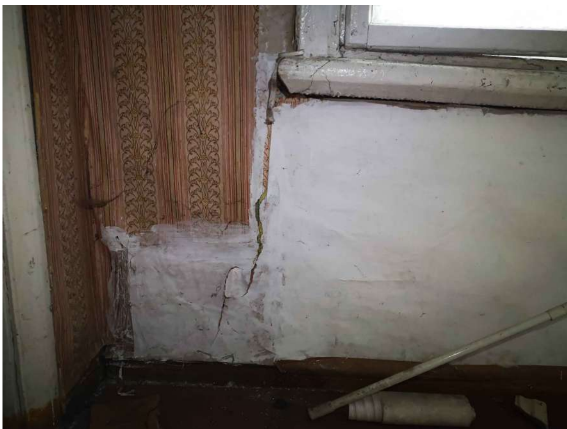
38.fotoattēls Deformācijas plaisas 2.stāva Z puses ārsienā.
