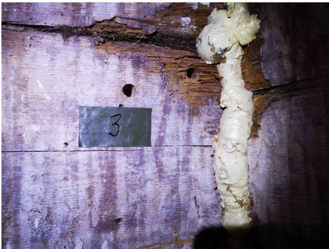
45.fotoattēls Kontrolurbumi 1.stāva nesošajā ārsienā.
