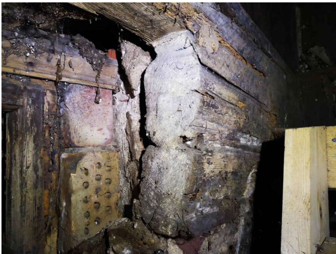
15.fotoattēls Apakšējā vainaga ārsienu konstrukcija (trupējusi).
