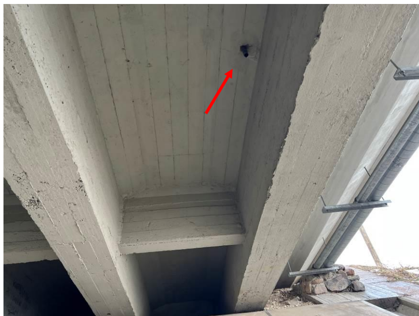
15.att. Trūkst kapilārā ūdens atvades caurulītes pagarinājums. Skats uz 3.laidumu no apakšas lejtecies pusē.
