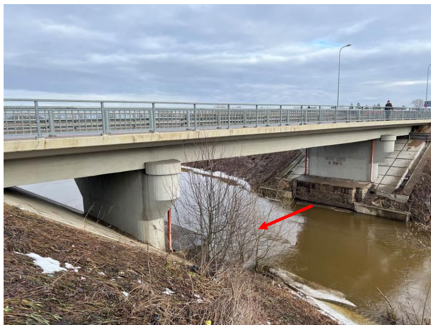
25.att. Pie tiltu konstrukcijām tuvu augoši krūmi. Skats augšteces pusē.
