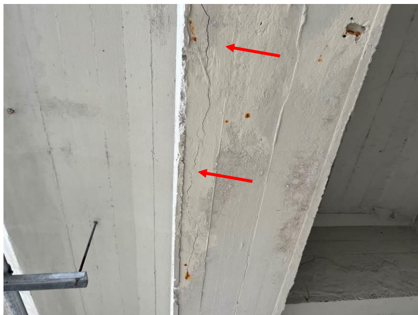
11.att. Korozijas plaisa fasādes sijā. Skats uz 1.laidumu no apakšas lejteces pusē.
