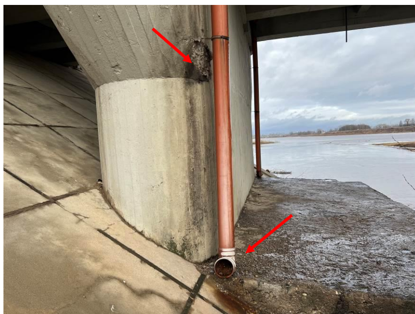
24.att. Aizsprostota ūdens atvades caurule, ūdens tek gar balstu. Skats uz upes balstu Nr.3 augštecē.
