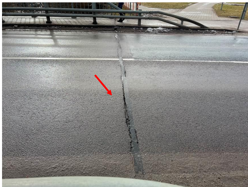
5.att. Iesēdums mastikā, plīsumi un plaisas. Skats virs krasta balsta Nr.4.
