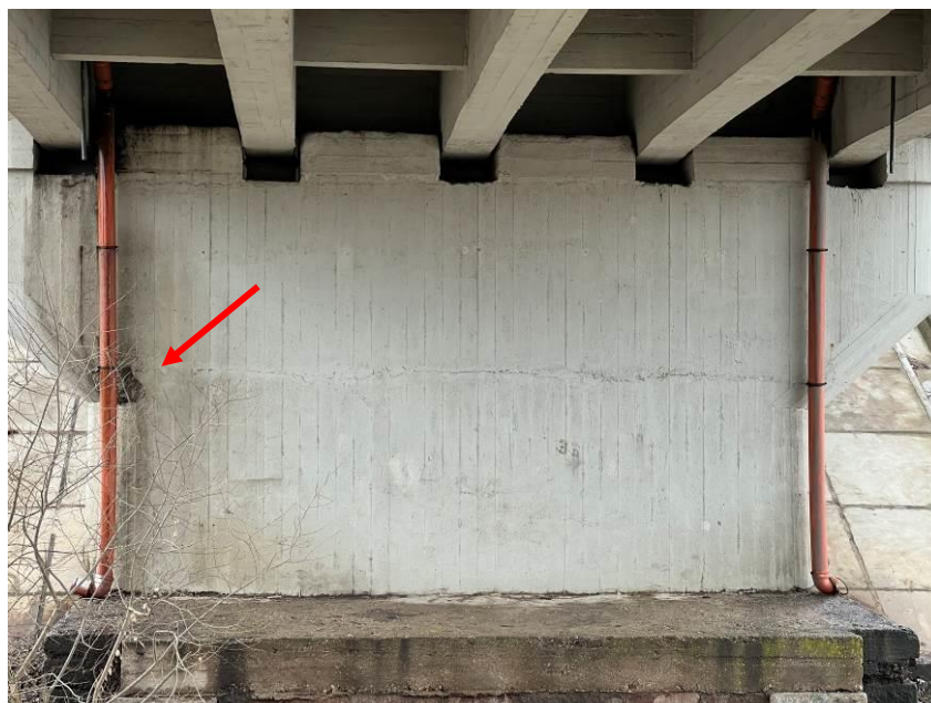
21.att. Bojātas ūdens atvades caurules rezultātā ūdens tek uz balsta ķermeni un drūp betons. Skats uz upes balstu Nr.3.
