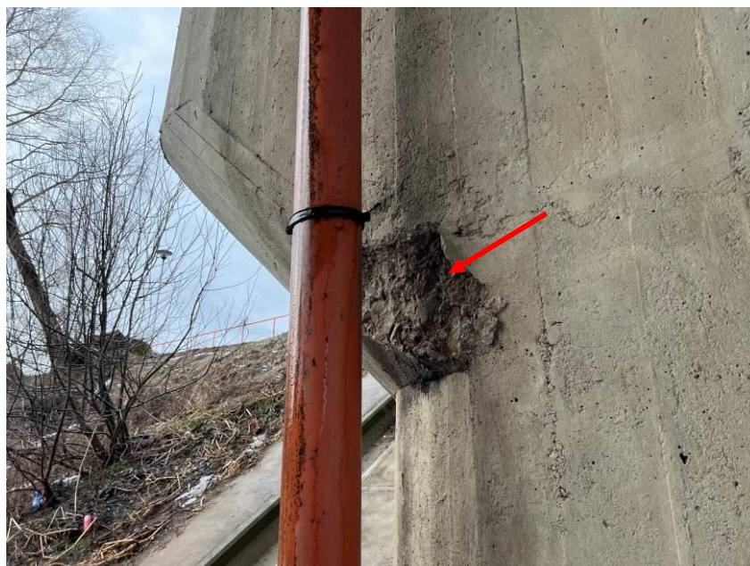
22.att. Bojātas ūdens atvades caurules rezultātā ūdens tek uz balsta ķermeni un drūp betons. Skats uz upes balstu Nr.3 augštecē.
