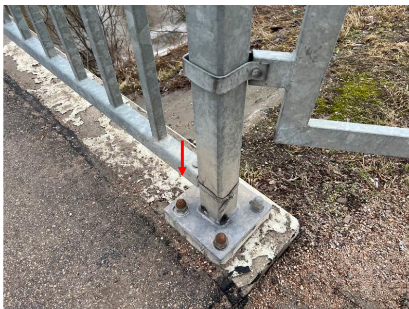
8.att. Korodē margu stabiņa skrūves. Skats pie krasta balsta Nr.4 augštecē.
