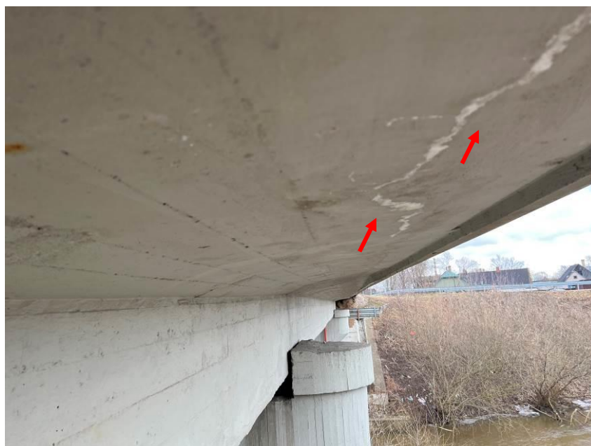
16.att. Ūdens notecējumi uz ietves konsoles. Skats uz 3.laidumu no apakšas augštecies pusē.
