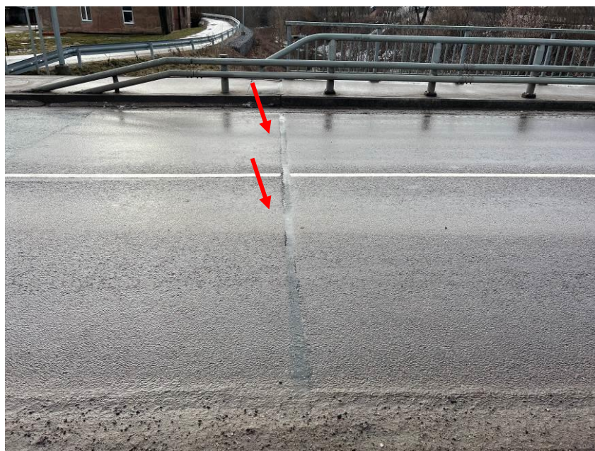
4.att Iesēdums mastikā un plaisas. Skats virs krasta balsta Nr.1.
