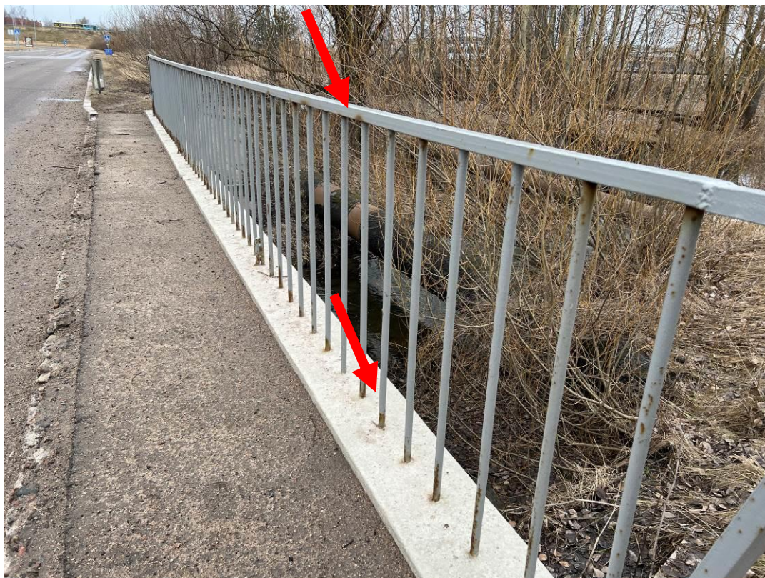
3.att. Sākusies tilta margu korozija.
