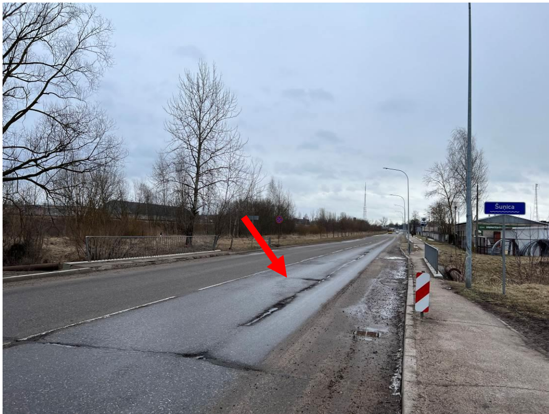
1.att. Avārijas bedres uz tilta brauktuves un pieejās.
