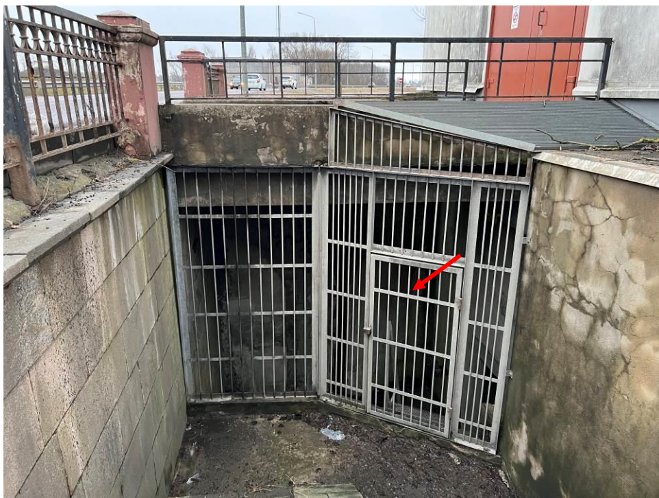
10.att. Slēgta velves konstrukcija. Skats lejteces pusē.
