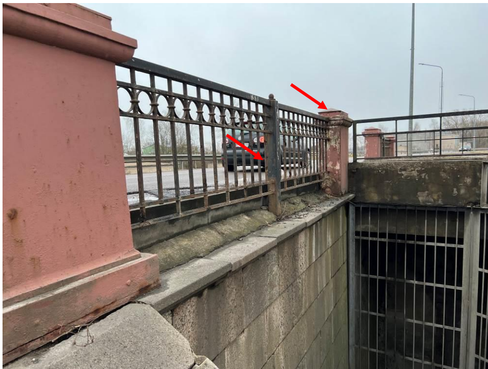
7.att. Korodē tērauda margas, drūp margu stabiņu betons. Skats lejteces pusē.
