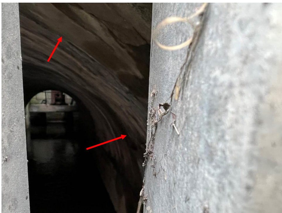
6.att. Ūdens caursūkšanās. Skats uz velvi no apakšas ieteces puses pie krasta balsta Nr.2.
