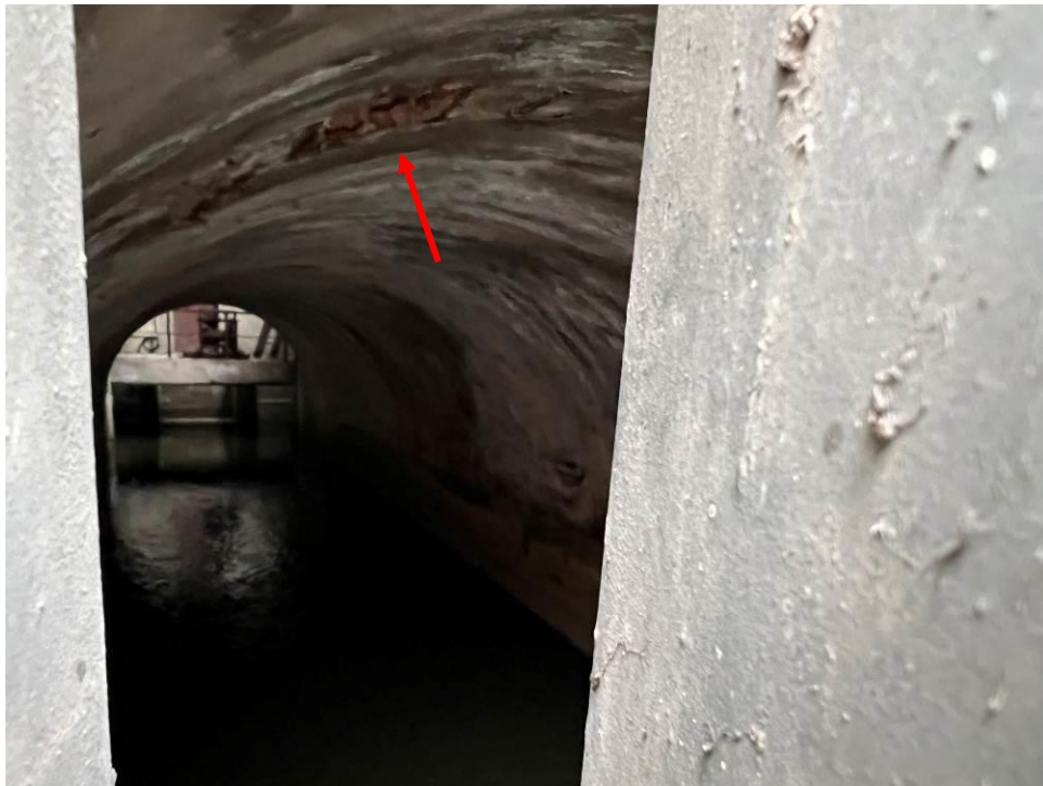
5.att. Ūdens caursūkšanās, betona izdrupums, stiegrojuma korozija. Skats uz velvi no apakšas ieteces puses.
