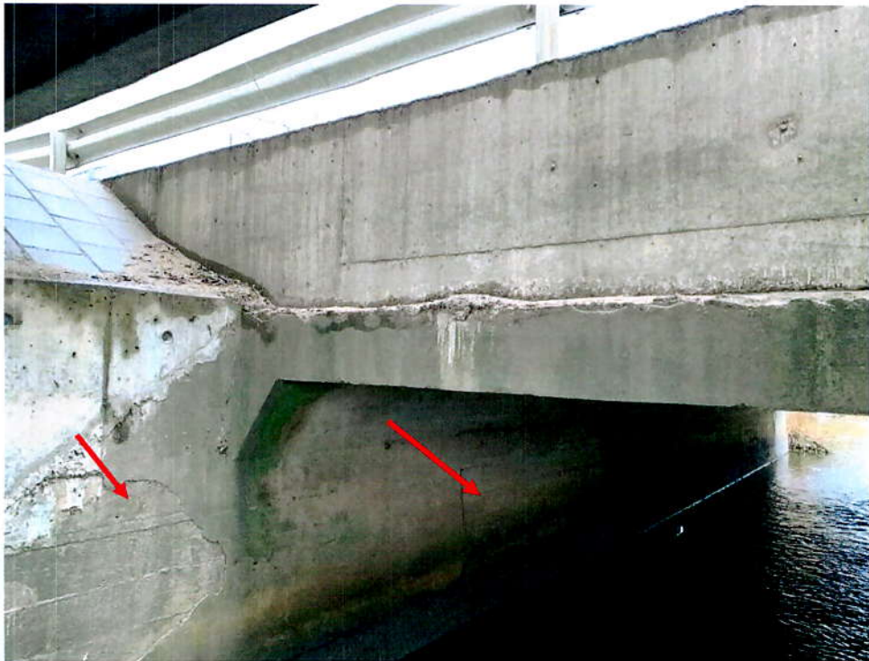
7.att. Vietām plēksnēm atdalās betons. Skats laidumā no augšteces puses.
