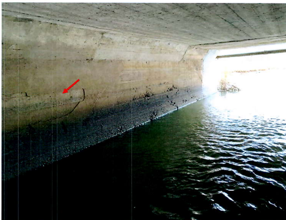
9.att. Vietām plēksnēm atdalās betons. Skats laidumā pie krasta balsta Nr.1 (Sporta ielas puse).
