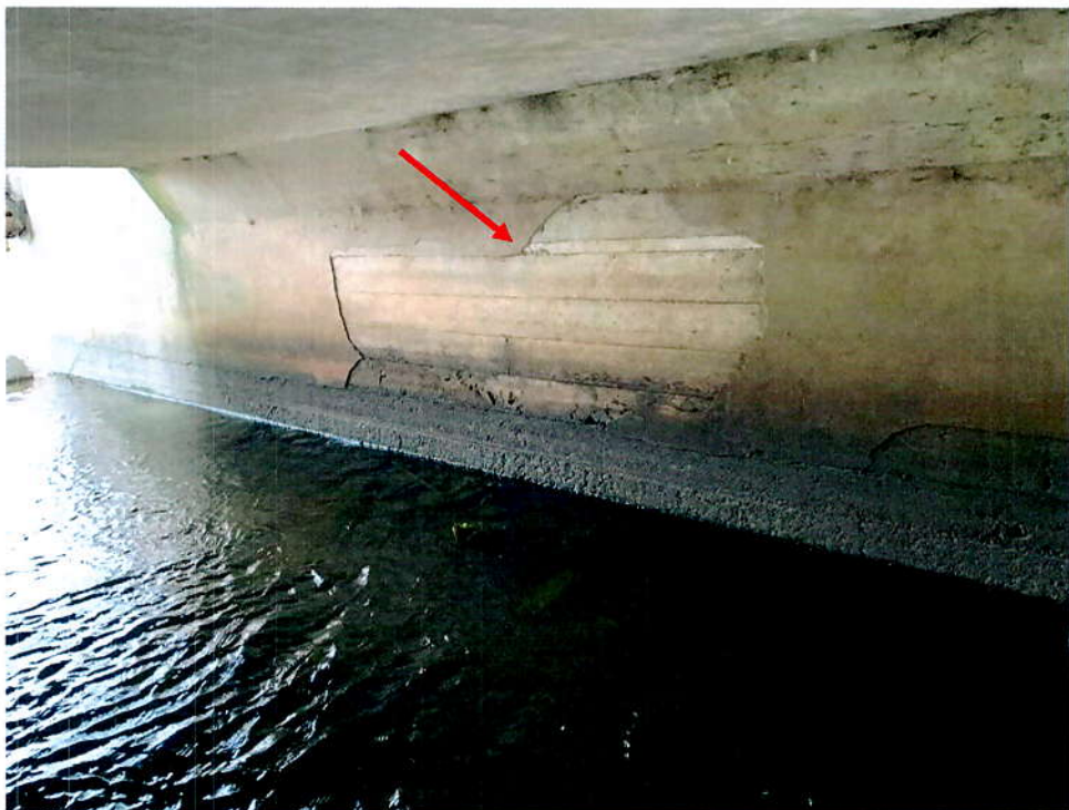
8.att. Vietām plēksnēm atdalās betons. Skats laidumā pie krasta balsta Nr.2 (Daugavas ielas puse).
