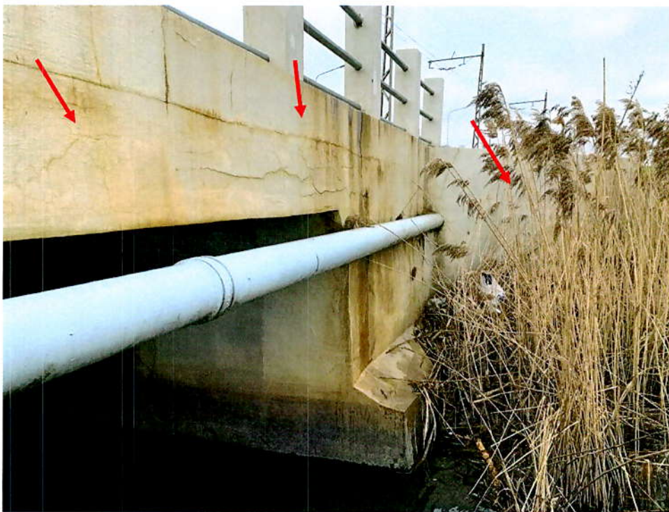
10.att. Notecējumi un plaisas uz laiduma fasādes daļas. Aug ūdenszāles. Skats uz laidumu no lejteces puses.
