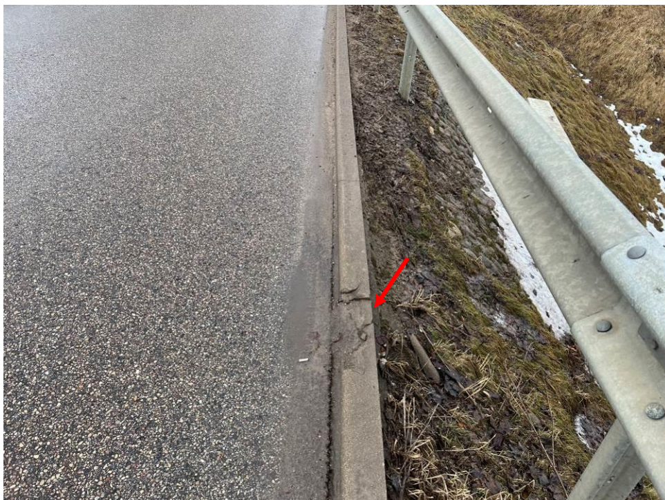
4.att. Mehānisks apmales akmeņa bojājums, plaisa savienojumā ar segumu Skats augštecies pusē.
