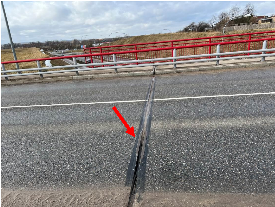
1.att. Sanesumi deformācijas šuvēs, izrauta gumiņa skats Centra pusē uz krasta balsta Nr.1.
