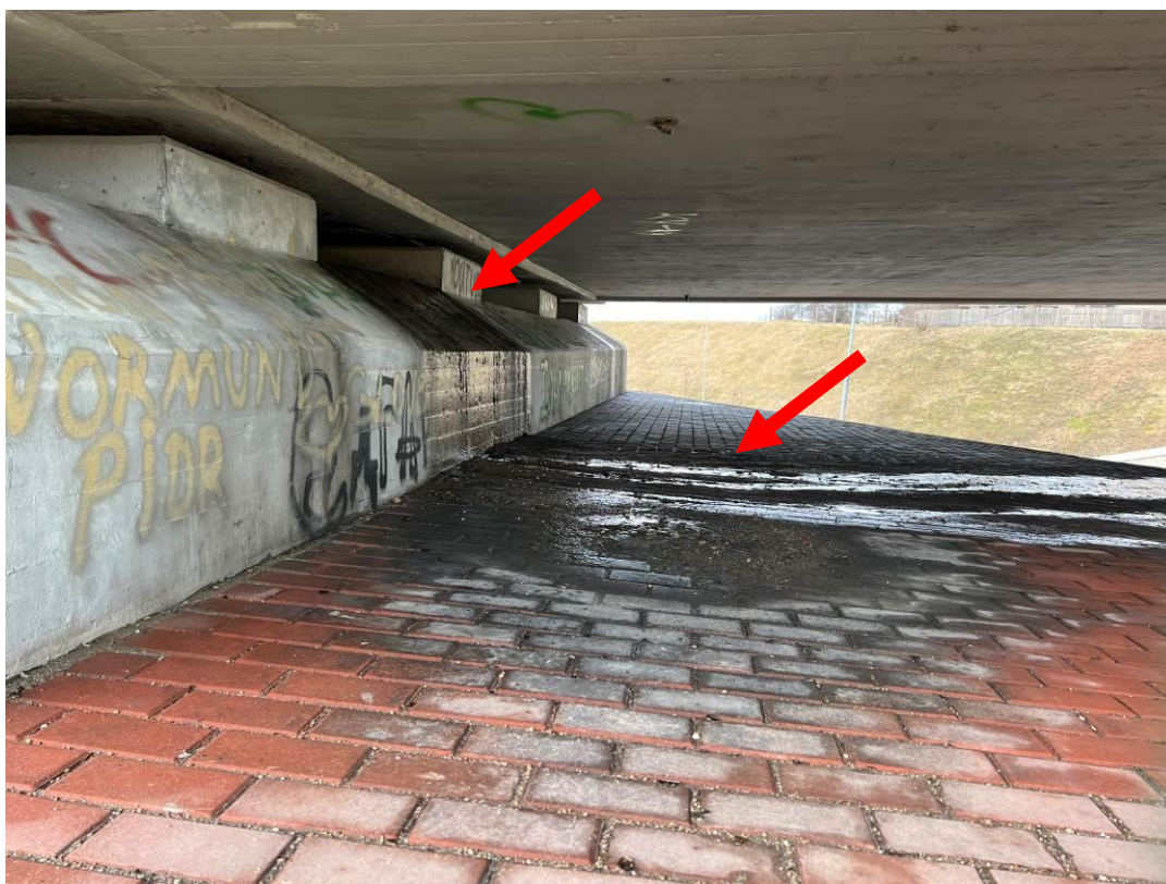
2.att. Ūdens tek caur deformācijas šuvi skats Centra pusē uz krasta balsta Nr.1.
