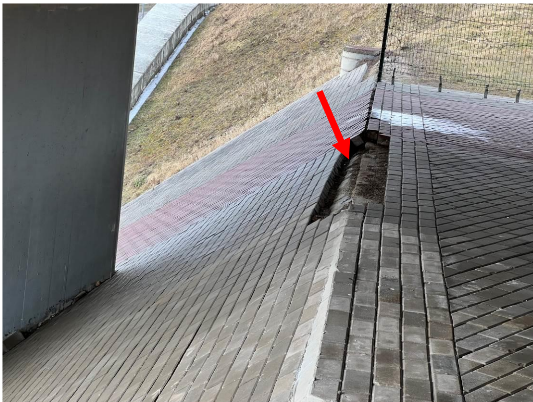
3.att. Bojāts konusa nostiprinājums, izlauzti akmeņi.
