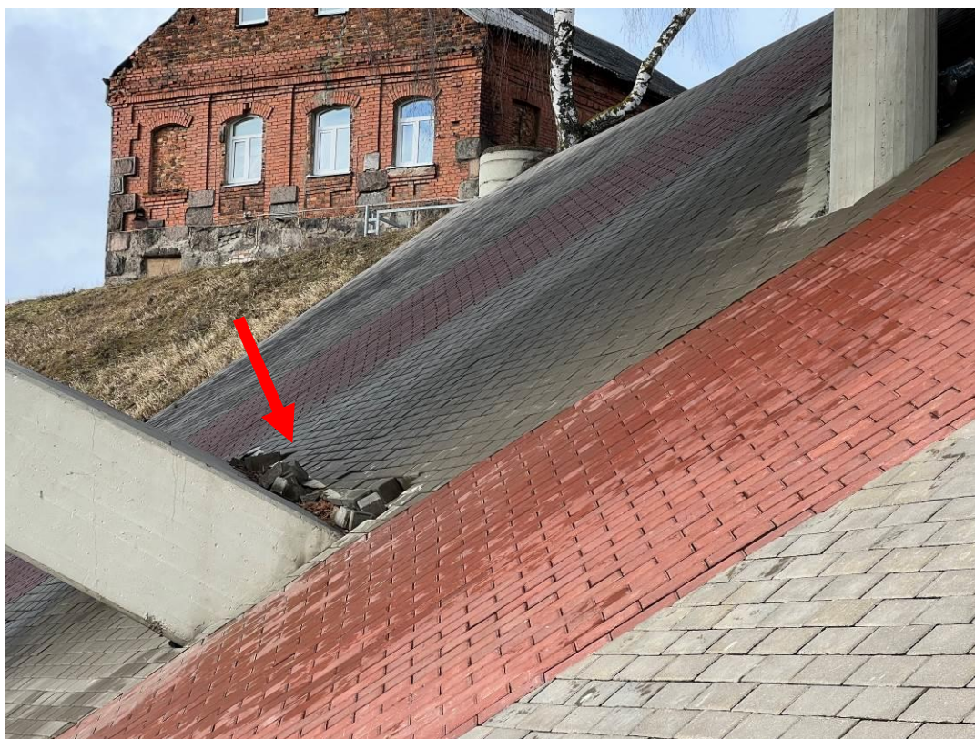
4.att. Bojāts konusa nostiprinājums, izlauzti akmeņi.
