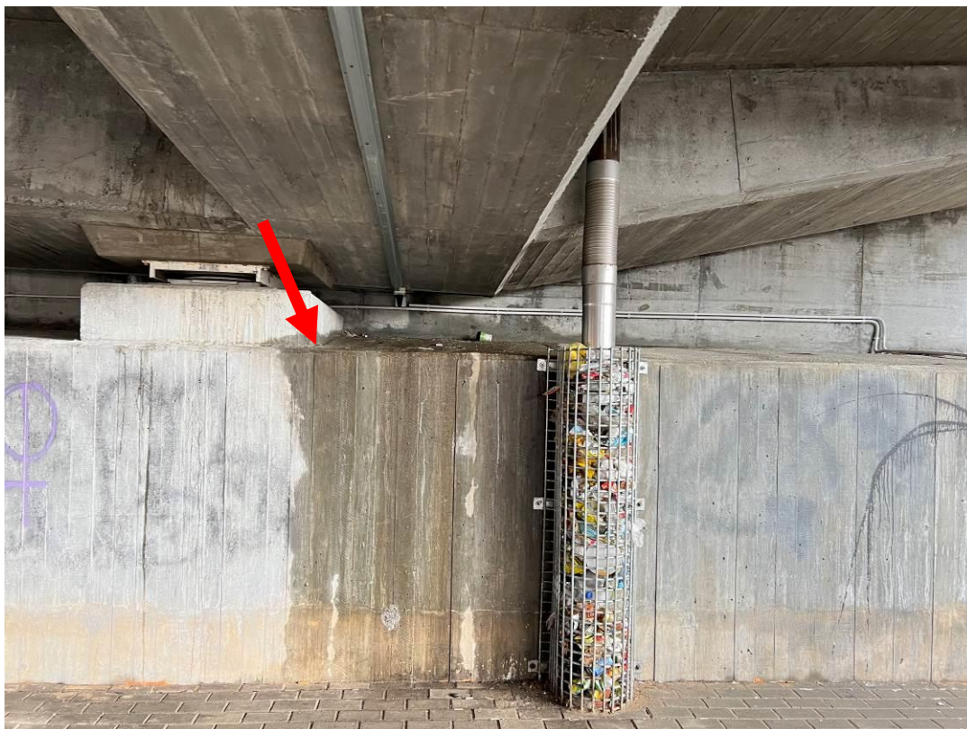
3.att. . Ūdens tek caur deformācijas šuvi.
