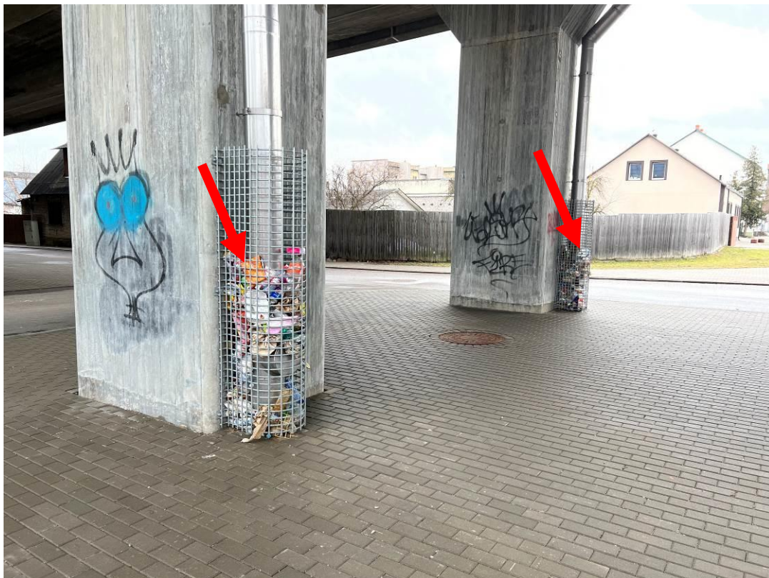
6.att. Atkritumi pie cauruļu aizsargrežģa, grafiti uz konstrukcijām.
