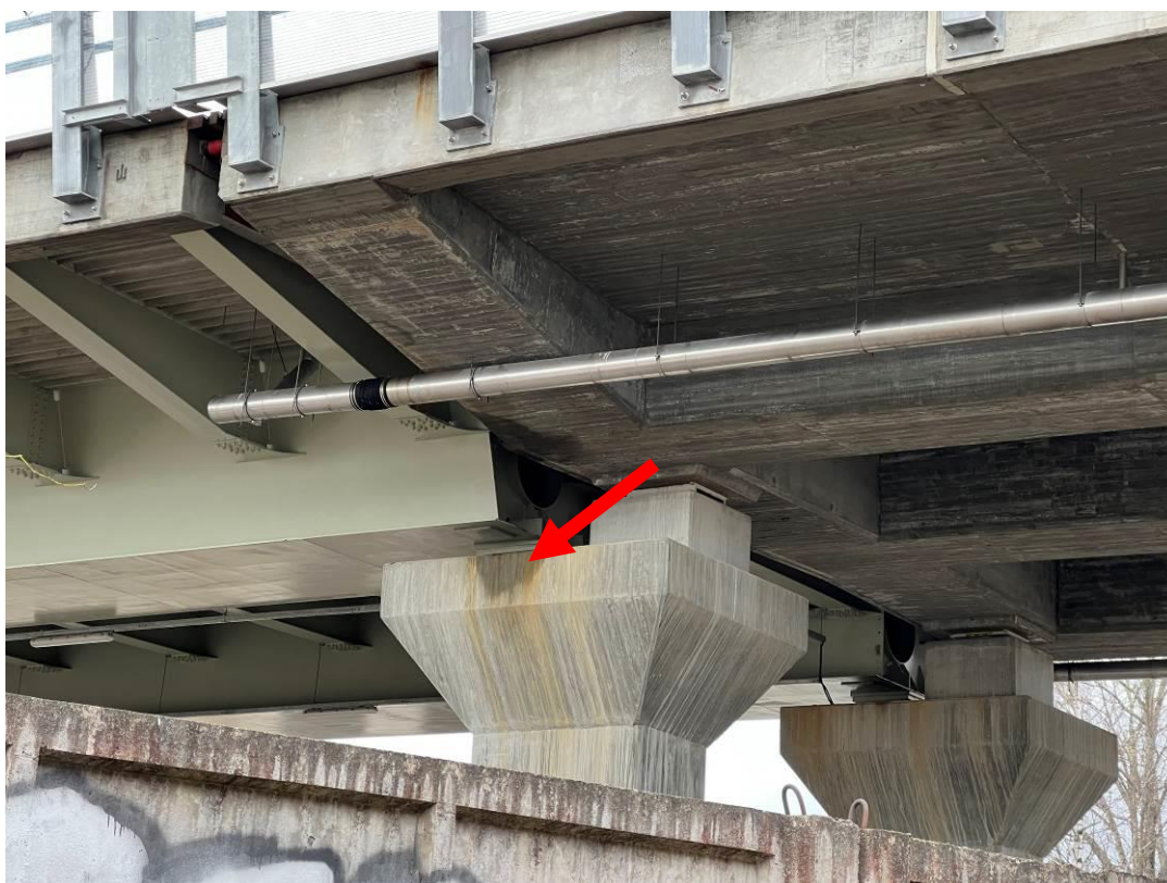
2.att. Ūdens tek caur deformācijas šuvi.
