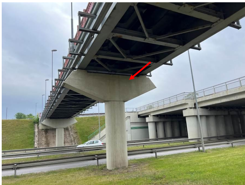
24.att. Korozijas plaisas balsta ķermenī. Skats uz starpbalstu Nr.3.
