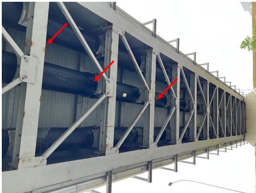
15.att. Sākusies tērauda konstrukcijas korozija. Skats uz 2.laidumu no apakšas (Andreja Pumpura ielas puse).
