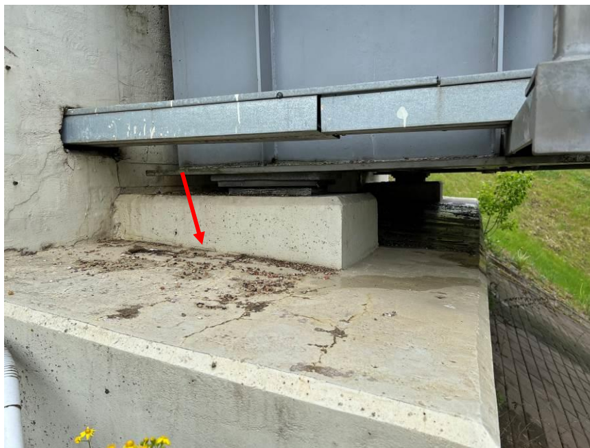
19.att. Ūdens notecējumi, sanesumi uz uzkalas. Skats uz krasta balstu Nr.1.
