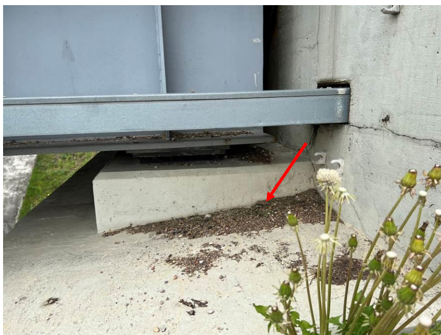
12.att. Ūdens tek caur deformācijas šuvei. Skats uz deformācijas šuvi virs krasta balsta Nr.4.
