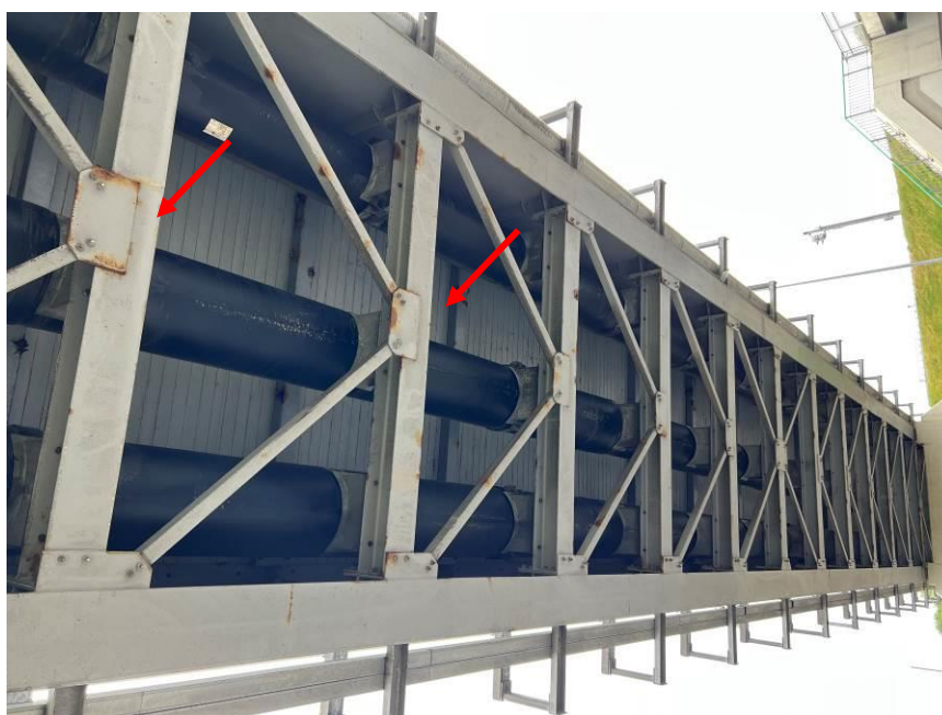
16.att. Sākusies tērauda konstrukcijas korozija. Skats uz 2.laidumu no apakšas (Slāvu ielas puse).
