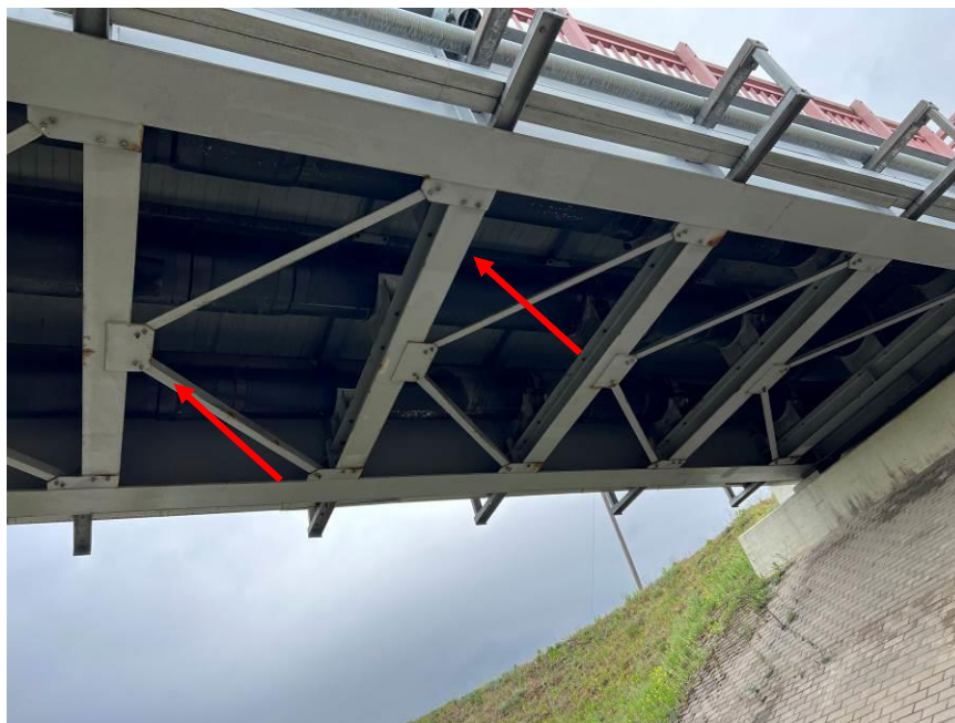
17.att. Sākusies tērauda konstrukcijas korozija. Skats uz 3.laidumu no apakšas.
