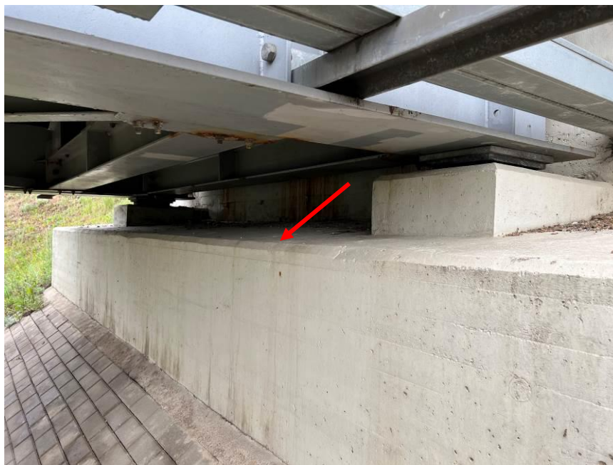
27.att. Ūdens notecējumi, sanesumi uz uzkalas. Skats uz krasta balstu Nr.4.
