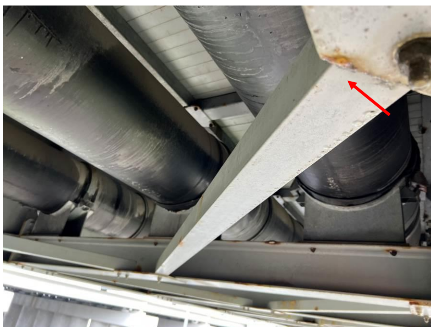
14.att. Sākusies tērauda konstrukcijas korozija. Skats uz 1.laidumu no apakšas.
