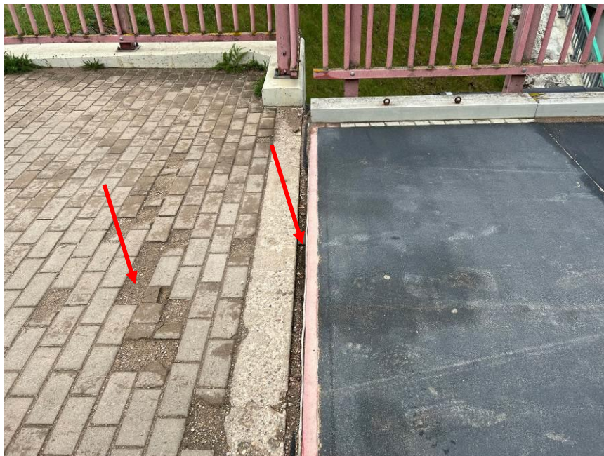
9.att. Ūdens tek caur deformācijas šuvei. Sadrupis bruģis pieejā. Skats uz deformācijas šuvi virs krasta balsta Nr.1.
