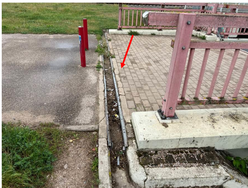
6.att. Sabrukusi ūdens atvades tekne, trūkst vāka. Skats uz ietvi pieejā pie krasta balsta Nr.1 (Andreja Pumpura ielas puse).
