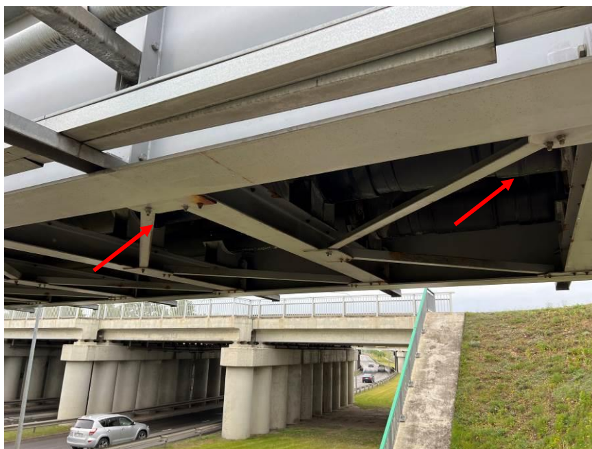
18.att. Sākusies tērauda konstrukcijas korozija. Skats uz 3.laidumu no apakšas.
