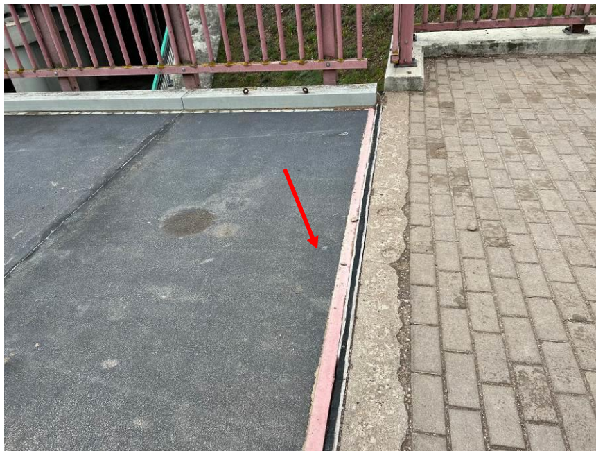
11.att. Ūdens tek caur deformācijas šuvei. Skats uz deformācijas šuvi virs krasta balsta Nr.4.
