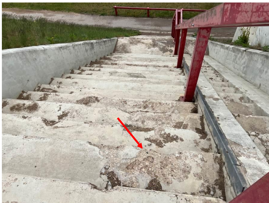
30.att. Drūp kāpņu betons, lobās krāsojums. Skats pie krasta balsta Nr.4.
