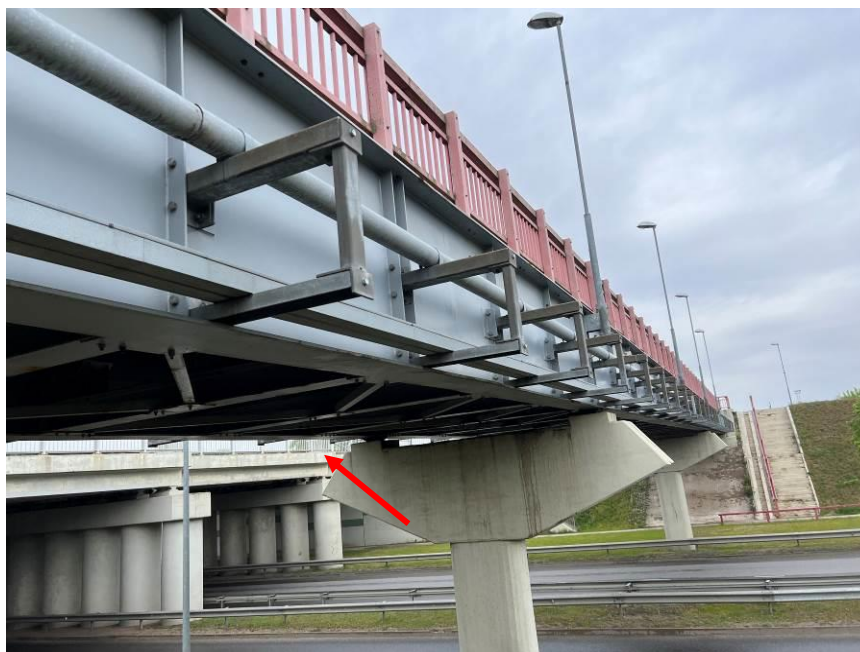
13.att. Sākusies tērauda konstrukcijas korozija. Skats uz 1.laidumu no apakšas.
