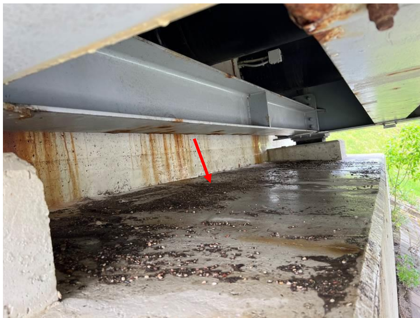
10.att. Ūdens notecējumi uz krasta balsta uzkalas. Skats uz krasta balsta Nr.1 uzkalu.
