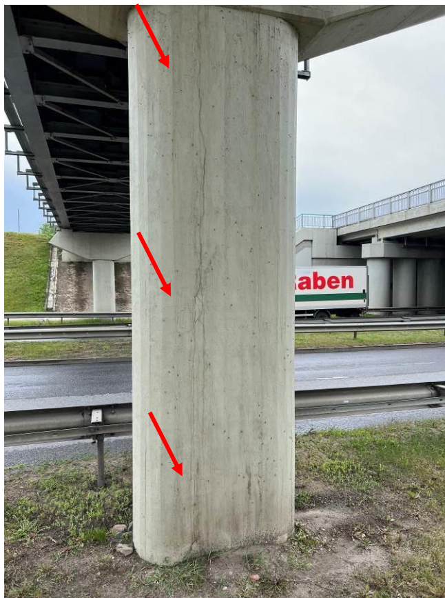
25.att. Korozijas plaisas balsta ķermenī. Skats uz starpbalstu Nr.3.
