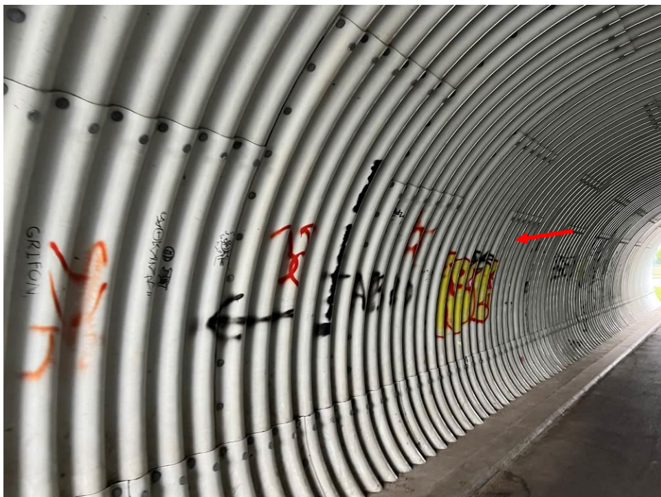
8.att. Grafiti zīmējumi uz tuneļa sienām. Skats tuneļa iekšpusē.
