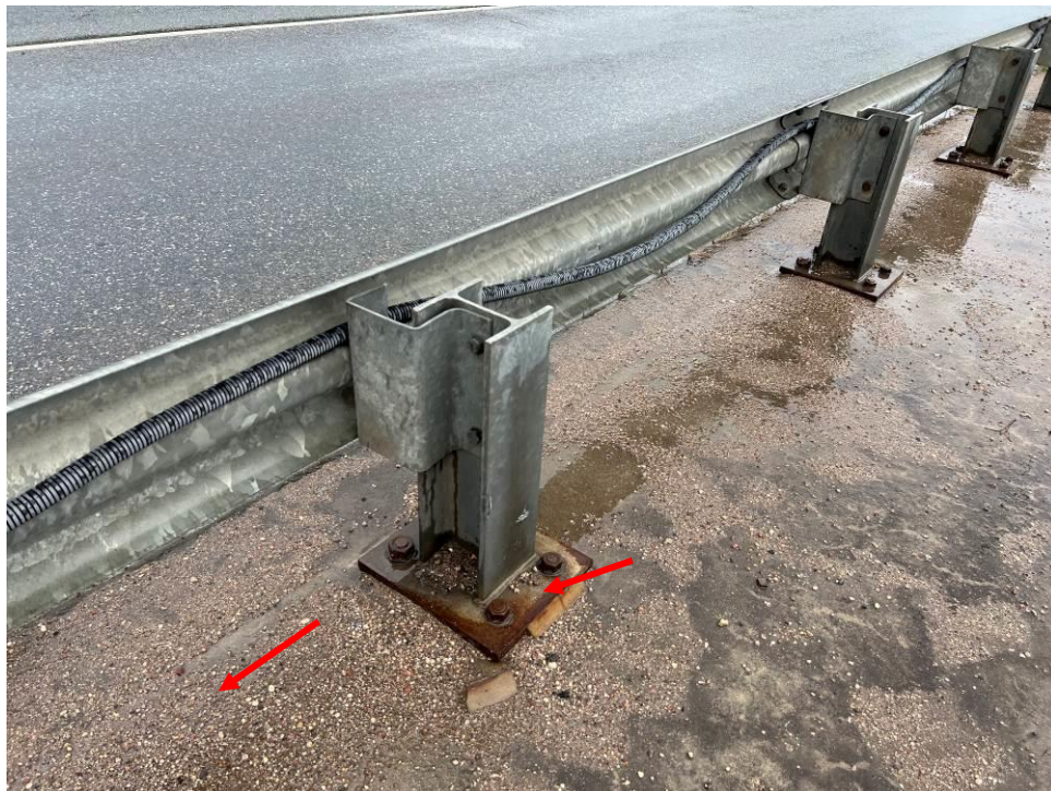
7.att. Barjeru stabiņu korozija pie pamata. Sanesumi uz ietves. Skats augšteces pusē.
