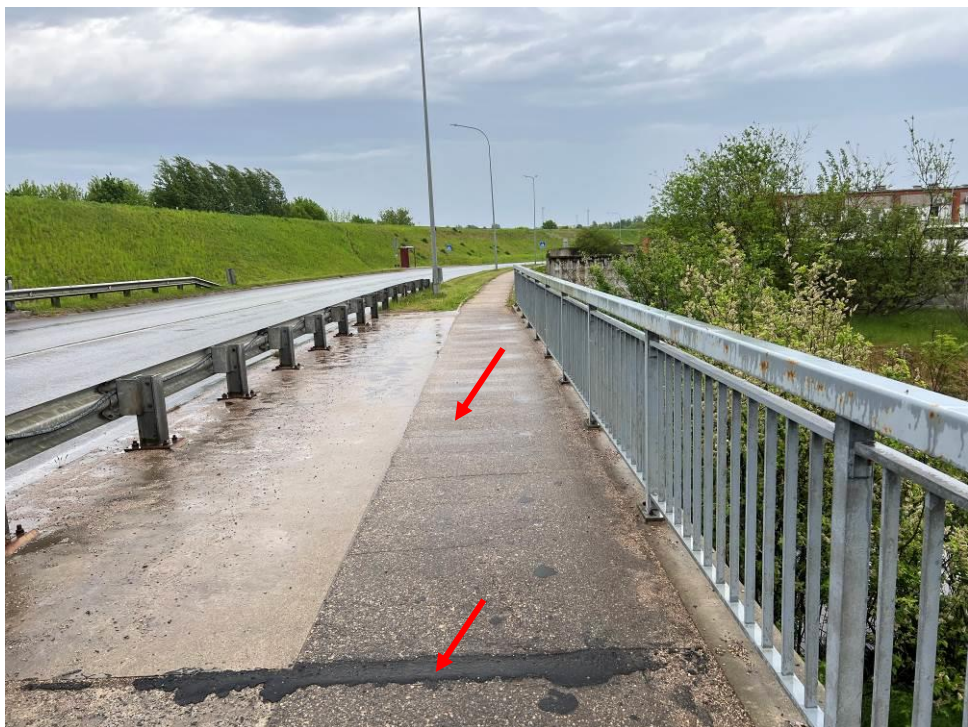
4.att. Nolietojies, saplaisājis ietves segums. Izspiesta ietves deformācijas šuves mastika. Skats augšteces pusē.
