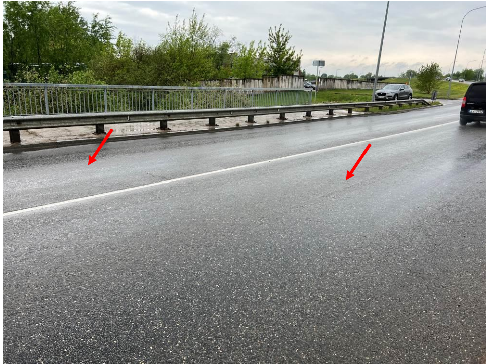
3.att. Veidojas brauktuves seguma nodilums, plaisas. Skats no krasta balsta Nr.2 puses (Vidzemes iela).
