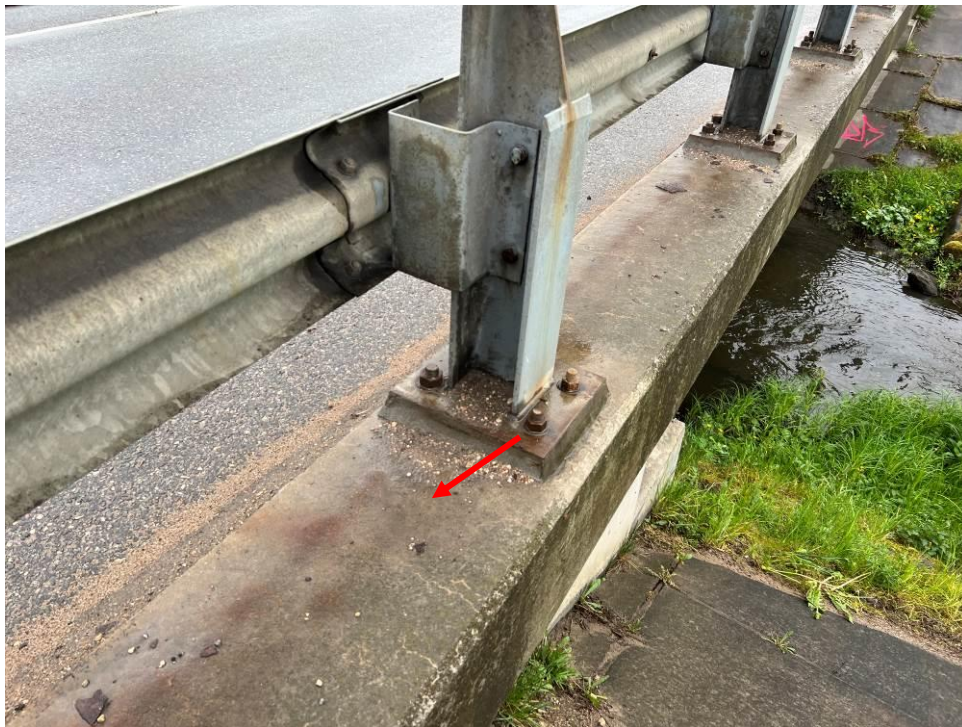
5.att. Notecējumi un sanesumi uz tilta karnīzes. Skats lejteces pusē.
