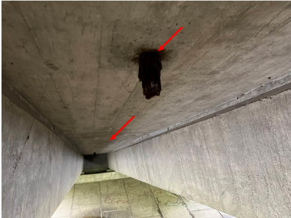
17.att. Korodējušas un sabrukušas kapilārās ūdens atvades caurulītes.
