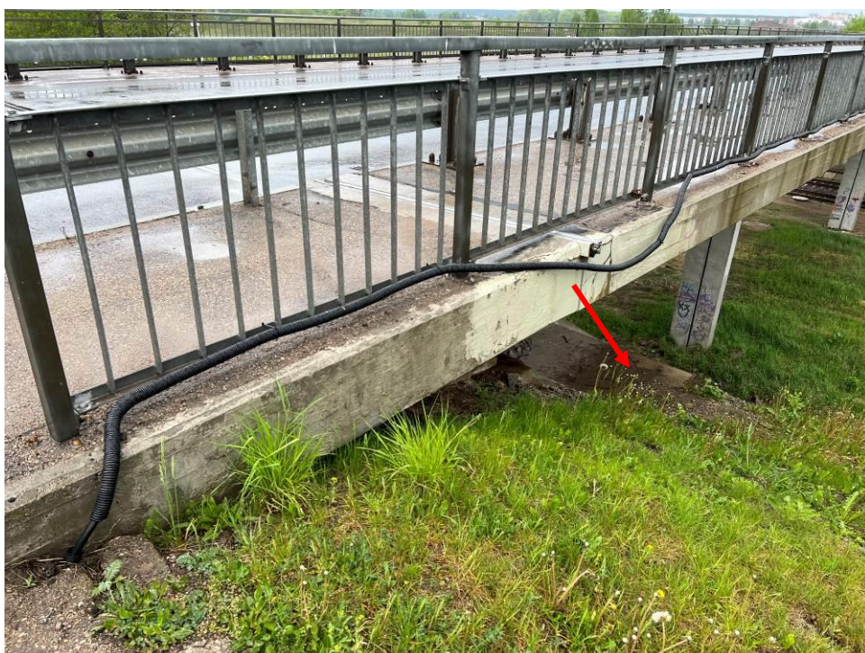
26.att. Pa margu konstrukciju izvilts elektrokabelis. Skats pie krasta balsta Nr.5.
