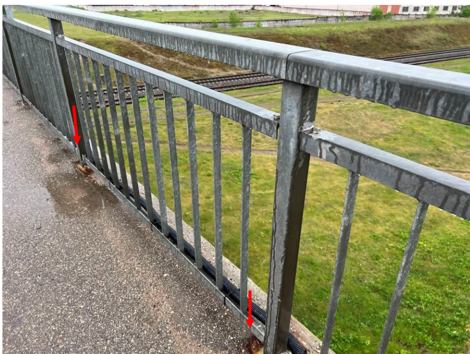
10.att. Uzgriežņu korozija margu stabiņam pie pamatnes. Skats centra pusē.
