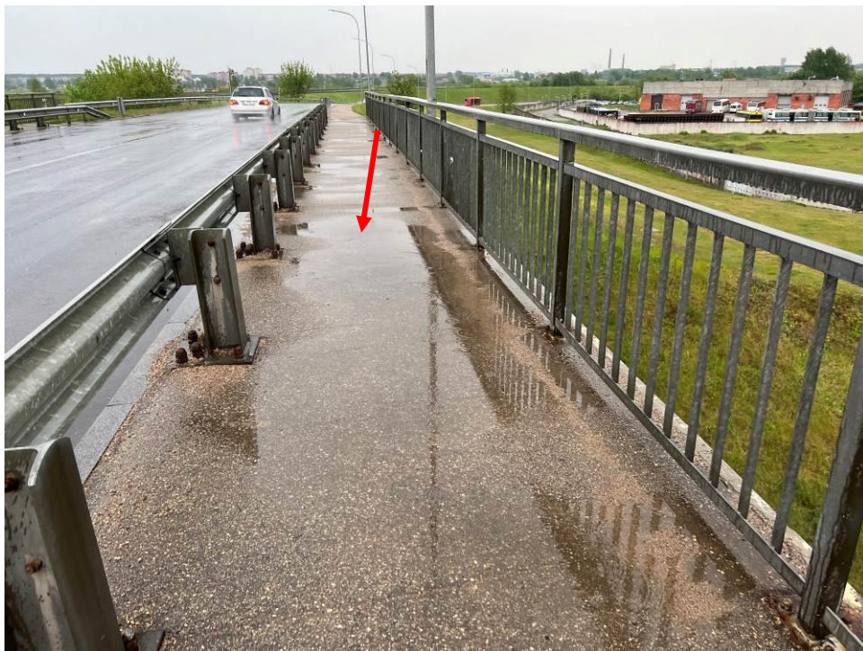
8.att. Nolietojies ietves asfaltbetona segums, plaisas, stāv ūdens. Skats centra pusē.
