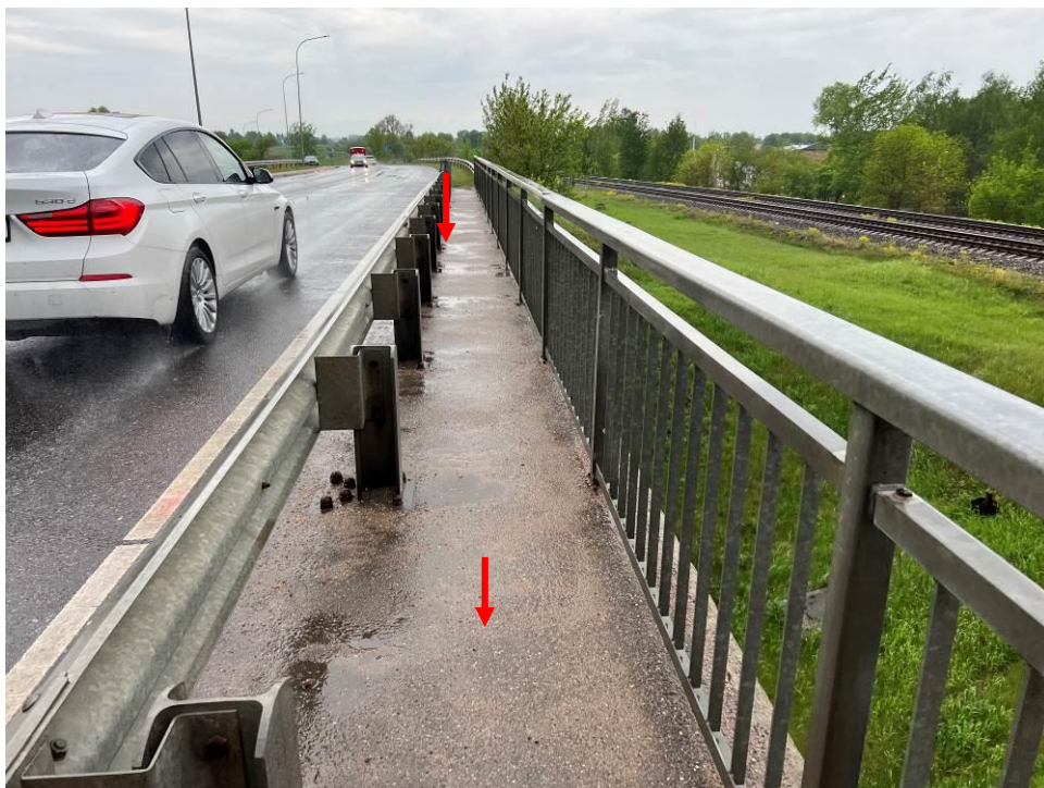
9.att. Nolietojies ietves asfaltbetona segums, plaisas, stāv ūdens. Skats dz/c pusē.
