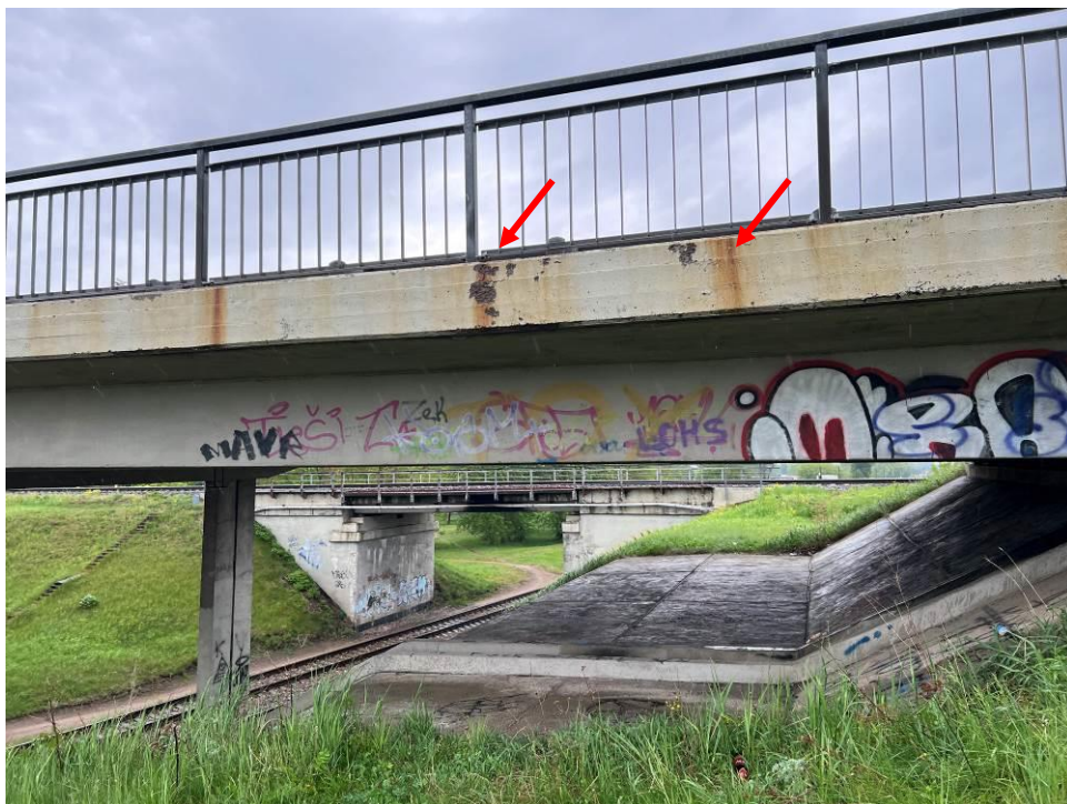
17.att. Ūdens notecējumi, betona izdrupumi karnīzē. Skats 1.laidumā centra pusē.
