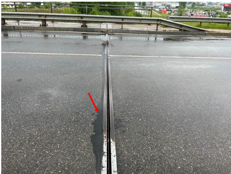
5.att. Izspiesta mastika pie šuves. Skats uz deformācijas šuve virs krasta balsta Nr.5.
