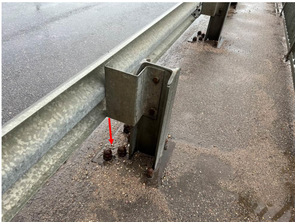
11.att. Skrūvju korozija barjeru stabiņam. Skats dz/c pusē.
