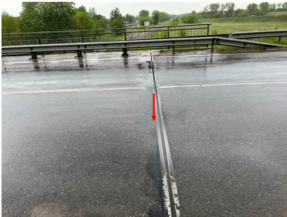
6.att. Izspiesta mastika pie šuves. Skats uz deformācijas šuve virs krasta balsta Nr.1.
