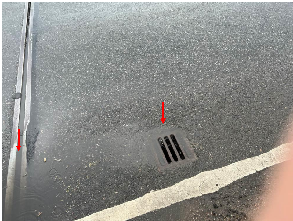
4.att. Stāv ūdens pie deformācijas šuves. Aizsērējumi gūlijā. Skats uz tilta brauktuvi pie krasta balsta Nr.5.
