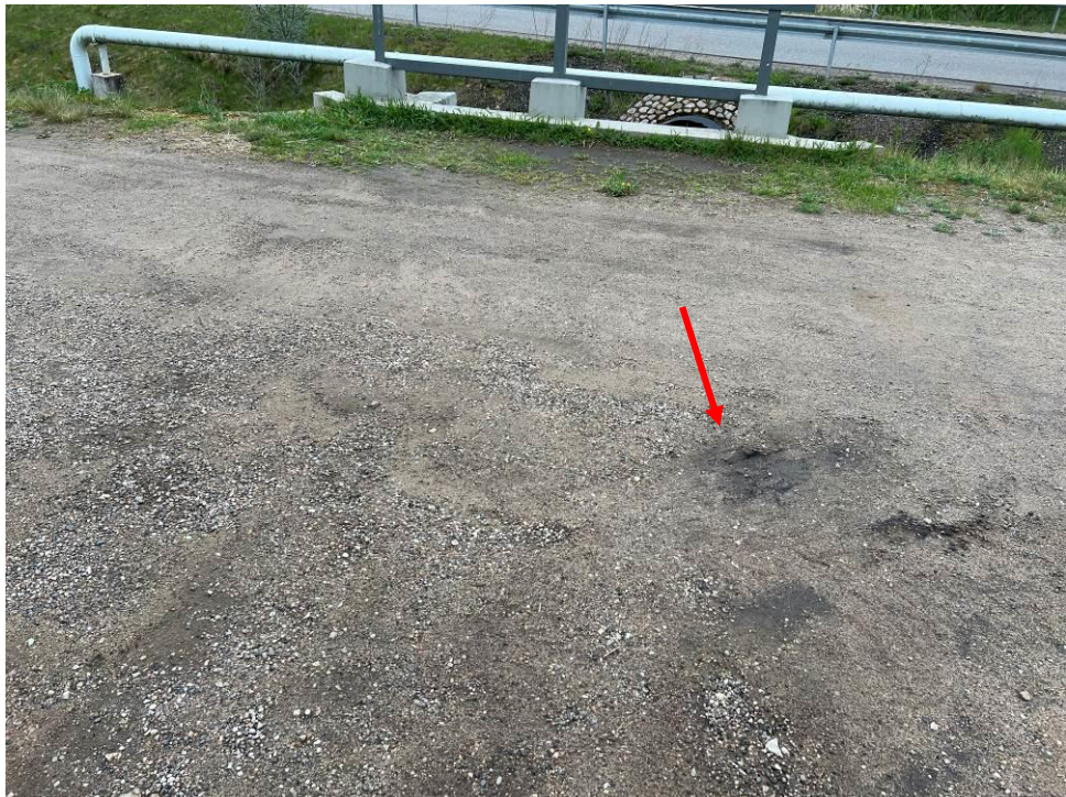
4.att. Veidojas dubļi. Skats uz tilta brauktuvi.
