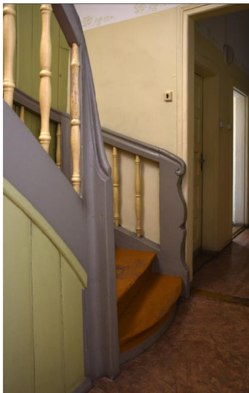
Skats uz 20. gs. sākumā iebūvēto kāpņu margu apakšējiem statņiem, kuri ailes vietā veido traucējošus izvīrzījumu. 2024. gada foto.
