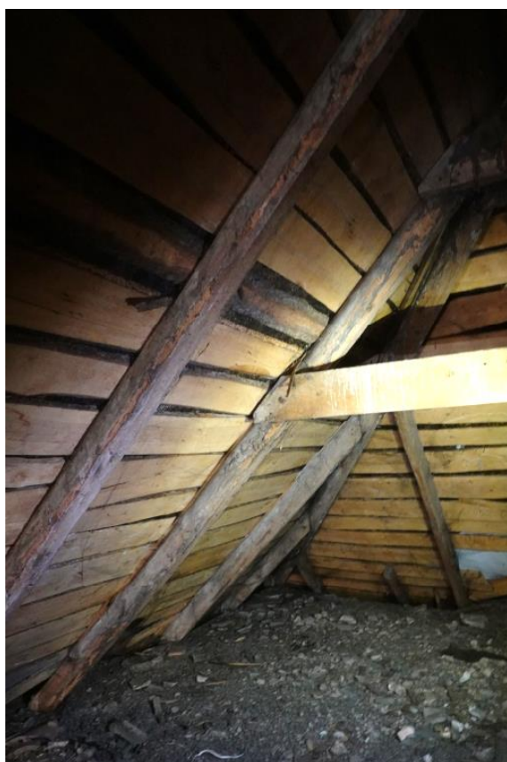
Skats uz jumta konstrukciju vietā, kur savienojas korpusa garākās un gala fasādes jumtu slīpnes. Redzami gan jumta stūra spāri balstošie atgāžņi, gan viens no pēdējās jumta seguma maiņas laikā spāru pārim pievienotajiem saišķiem. 2025. g. foto
