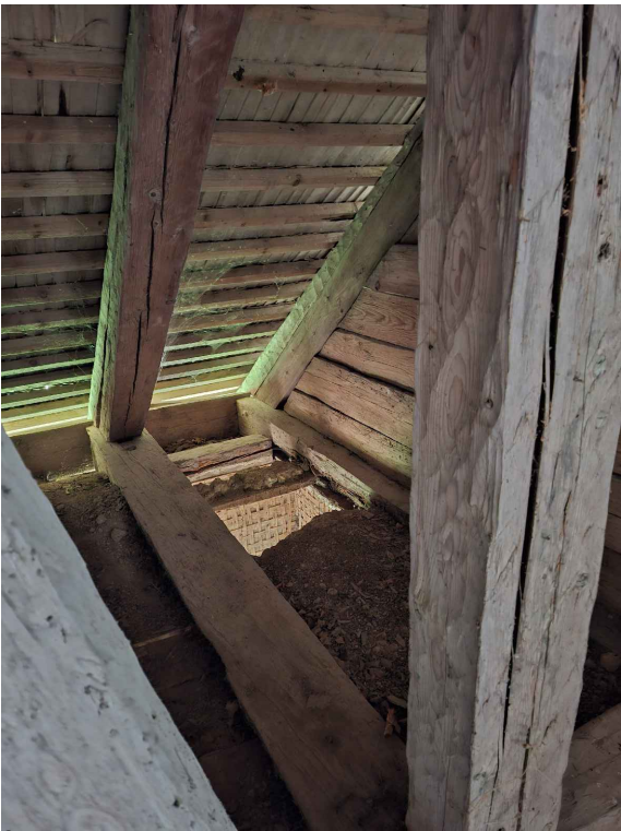
Skats bēniņos uz bojāto 1. stāva pārsegumu ēkas dienvid-rietumu stūrī.
