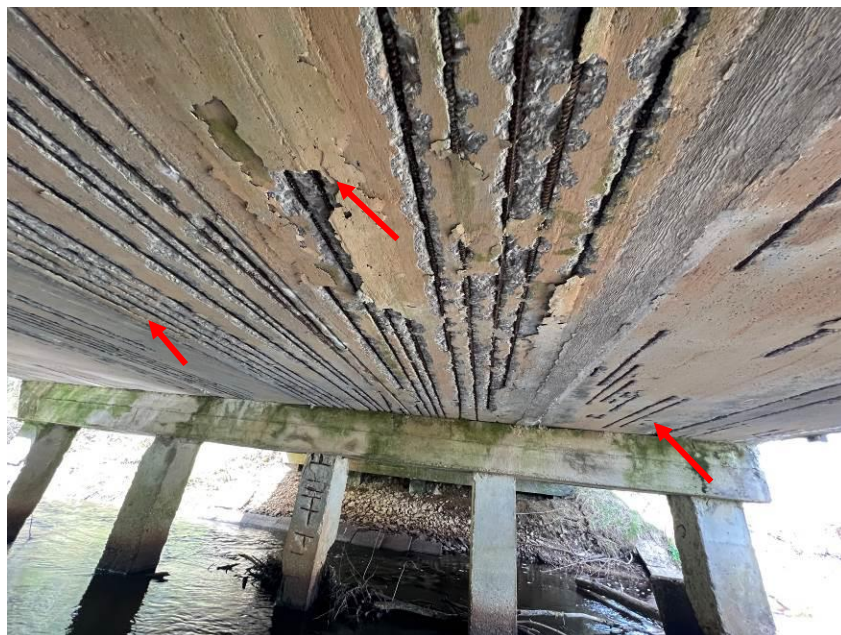
7.att. Nodrupis laiduma konstrukcijas betons, atsegts korodē darba stiegrojums, notiek ūdens caursūkšanās. Skats uz 2.laidumu.
