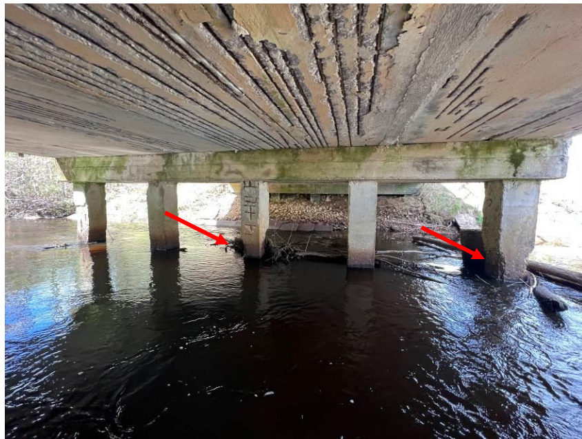
11.att. Bojāti balsta pāļi – drūp betons un korodē darba stiegrojums. Skats uz upes balstu Nr.2.
