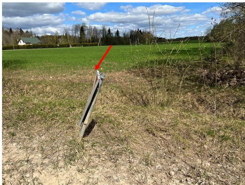
16.att. Bojāta c/z 907. Skats pie krasta balsta Nr.1 augštecē.
