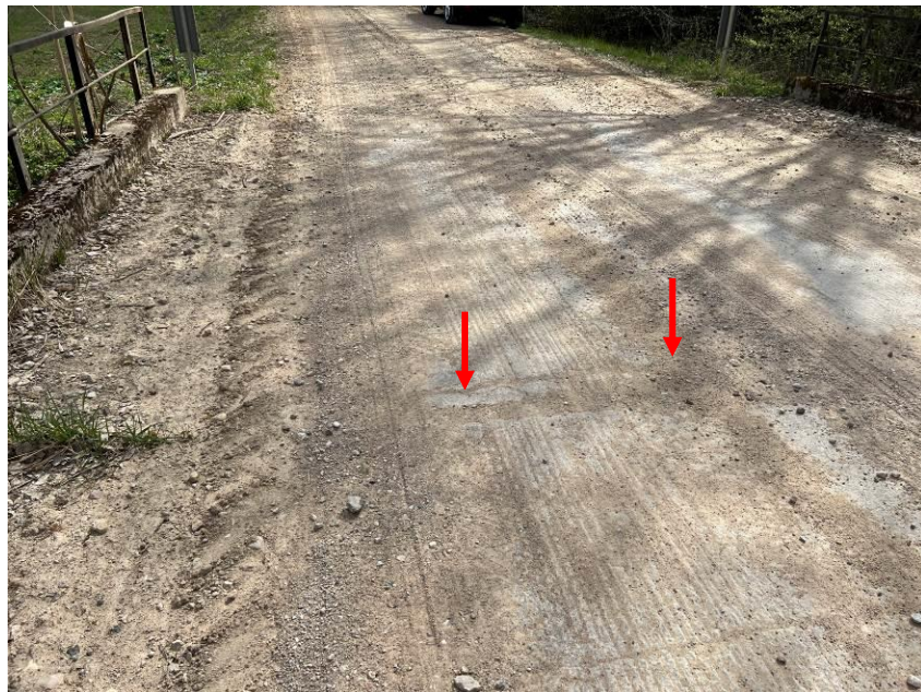
4.att. Iesēdums virs deformācijas šuves tilta brauktuvē. Skats virs upes balsta Nr.2
