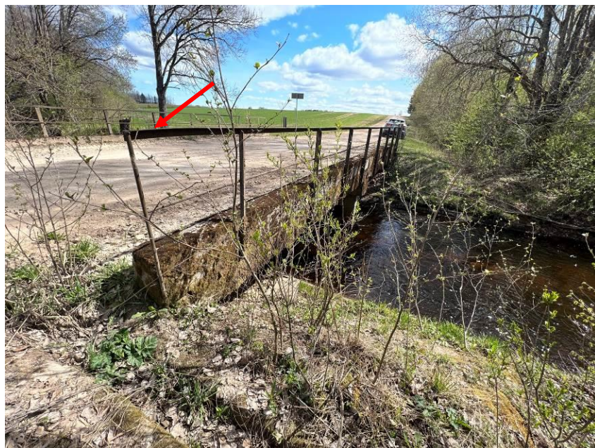
6.att. Mehāniski bojāta un korodē tilta marga. Skats 1.laidumā augšteces pusē.
