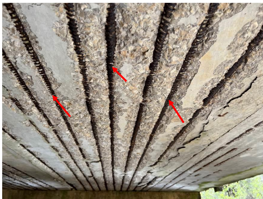
8.att. Nodrupis laiduma konstrukcijas betons, atsegts korodē darba stiegrojums, notiek ūdens caursūkšanās. Skats uz 1.laidumu.
