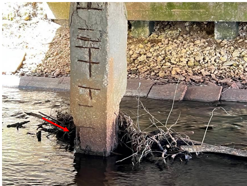
12.att. Bojāti balsta pāļi – drūp betons un korodē darba stiegrojums. Skats uz upes balstu Nr.2.
