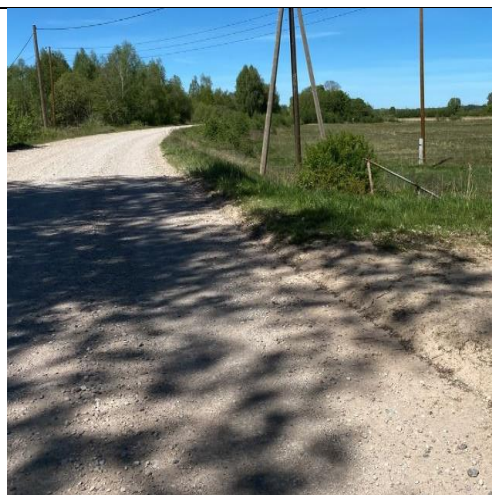
Attēls Nr.8 – Aizsargdambja nogāzē 20 kV elektrolīnijas balsts, Pik. 07/00.
