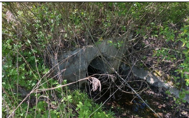
Attēls Nr.2 – Skats uz caurtekas izplūdes daļu Pik. 01/30. Grāvis 385321:K:12
