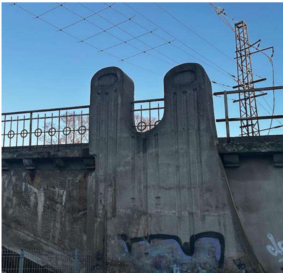
12. att. Laiduma sānu virsmā konstatētas plaisas, kā arī balsta dekoratīvā elementa bojājumi ar lokāliem betona izdrupumiem. Skats virzienā uz Rīgu.
