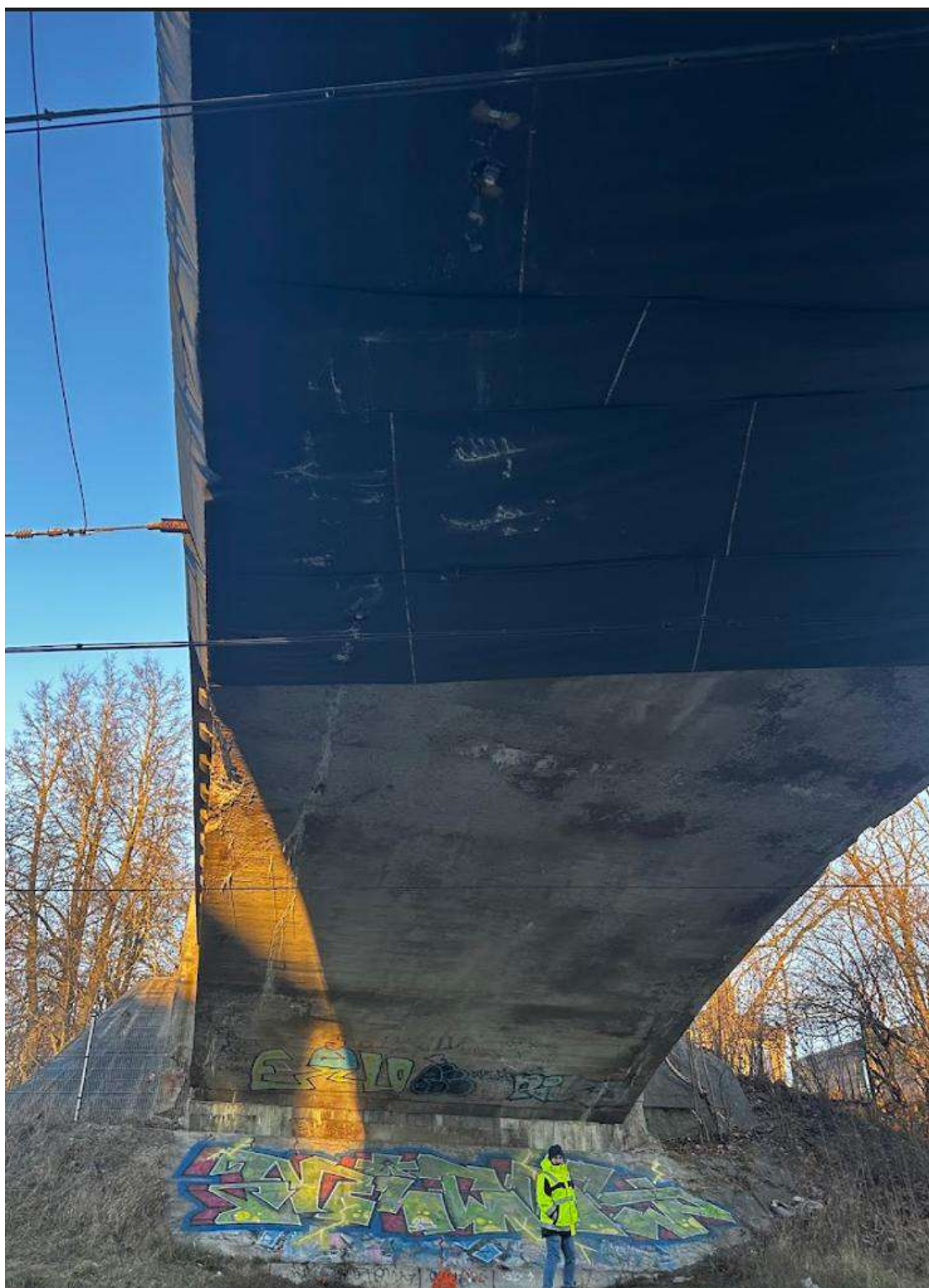
10. att. Velves apakšējā daļā betonā novērojamas vairākas plaisas ar izskalošanās pazīmēm, kā arī betona izdrupumi. Laidums ir pārsegts ar aizsargsietiem, lai pasargātu dzelzceļa infrastruktūru no iespējamās betona bojātu fragmentu atdalīšanās.
