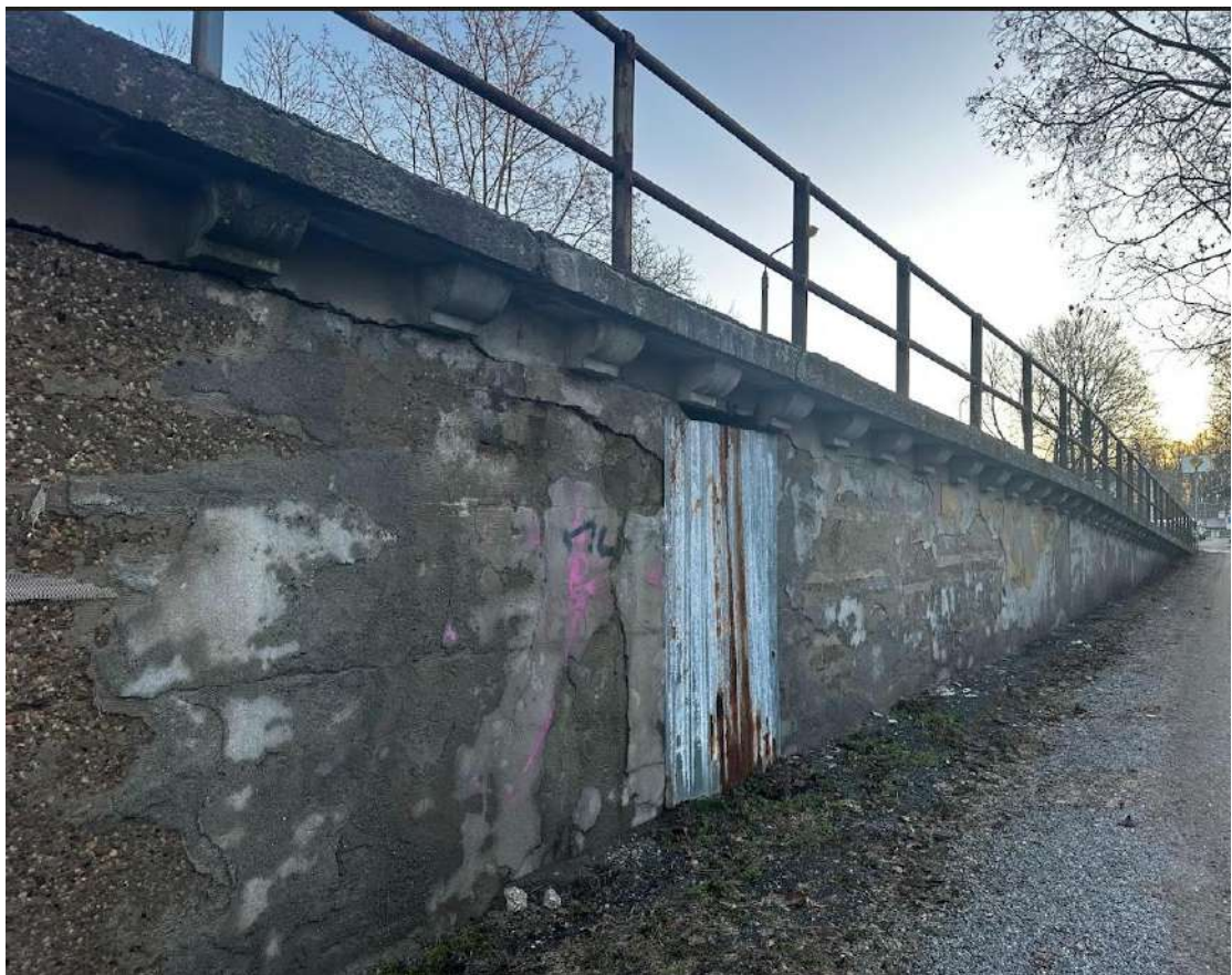
15.,16. un 17. att. Atbalstsienas redzamās virsmas defekti: plaisas, kā arī dekoratīvo elementu bojājumi.
