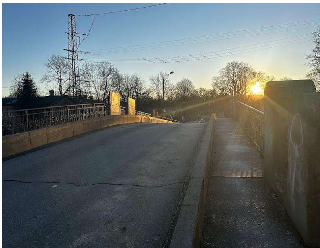
9. att. Balstu zonā visā brauktuves un ietves platumā novērojamas asfaltbetona seguma šķērsvirziena plaisas.
