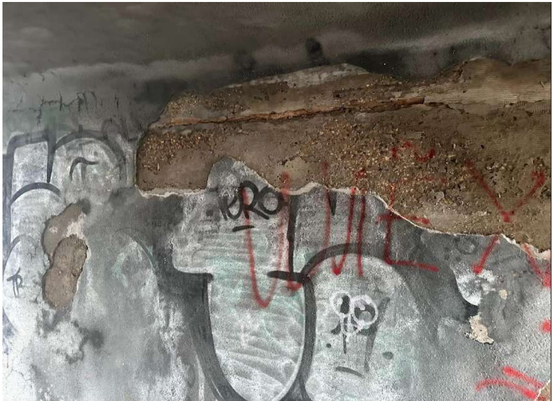
15. att. Konstatēti tuneļa iekšējo sienu bojājumi: betona plaisas un remontsastāva atslāņošanās.
