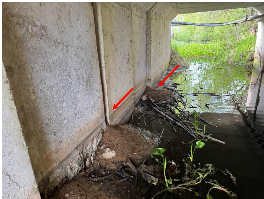
12.att. Nobīdījušies posmi, betona izdrupumi mainīgajā ŪL zonā, bojātas posmu saduršuves, tiek skalota uzbēruma smiltis. Skats caurtekas iekšpusē pie krasta balsta Nr.1 no izteces puses.
