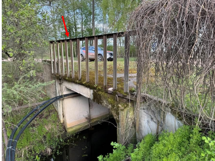
9.att. Korodē tilta margas, vietām bojāts stiprinājums pie pamata. Skats uz margu konstrukciju augštes pusē.
