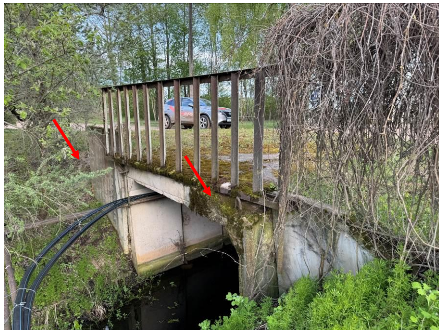
18.att.Nekvalitatīvs betons, betona izdrupumi, ūdens caursūkšanās. Skats uz sānu sienu pie krasta balsta Nr.1 augšteces pusē.
