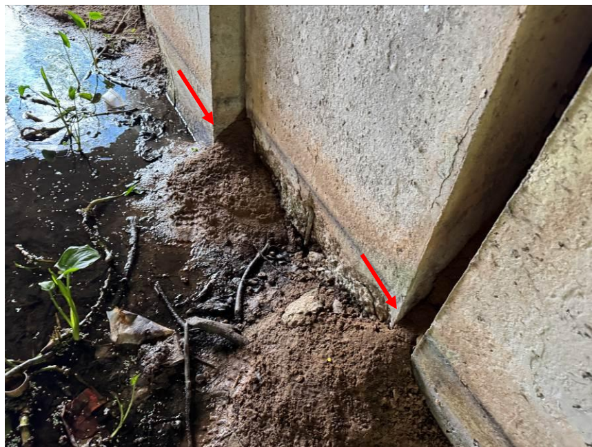
16.att. Nobīdījušies posmi, betona izdrupumi mainīgajā ŪL zonā, bojātas posmu saduršuves, tiek skalota uzbēruma smiltis. Skats caurtekas iekšpusē pie krasta balsta Nr.1 no ieteces pusē.
