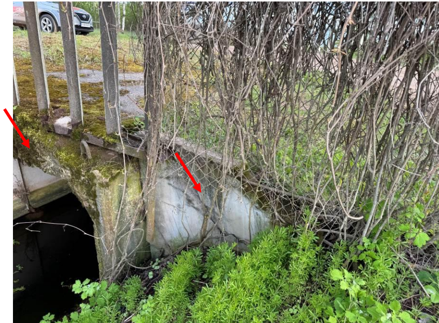
17.att.Nekvalitatīvs betons, betona izdrupumi, ūdens caursūkšanās. Skats uz sānu sienu pie krasta balsta Nr.1 augšteces pusē.
