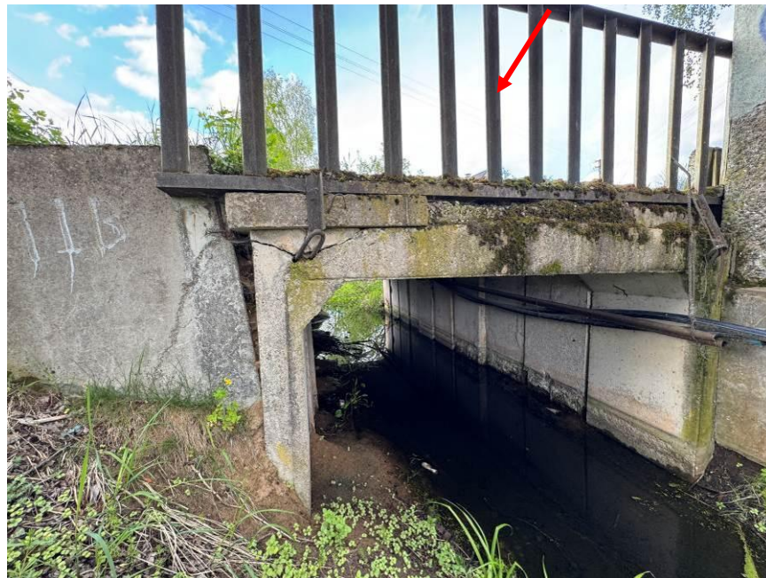
10.att. Korodē tilta margas, vietām bojāts stiprinājums pie pamata. Skats uz margu konstrukciju lejtes pusē.
