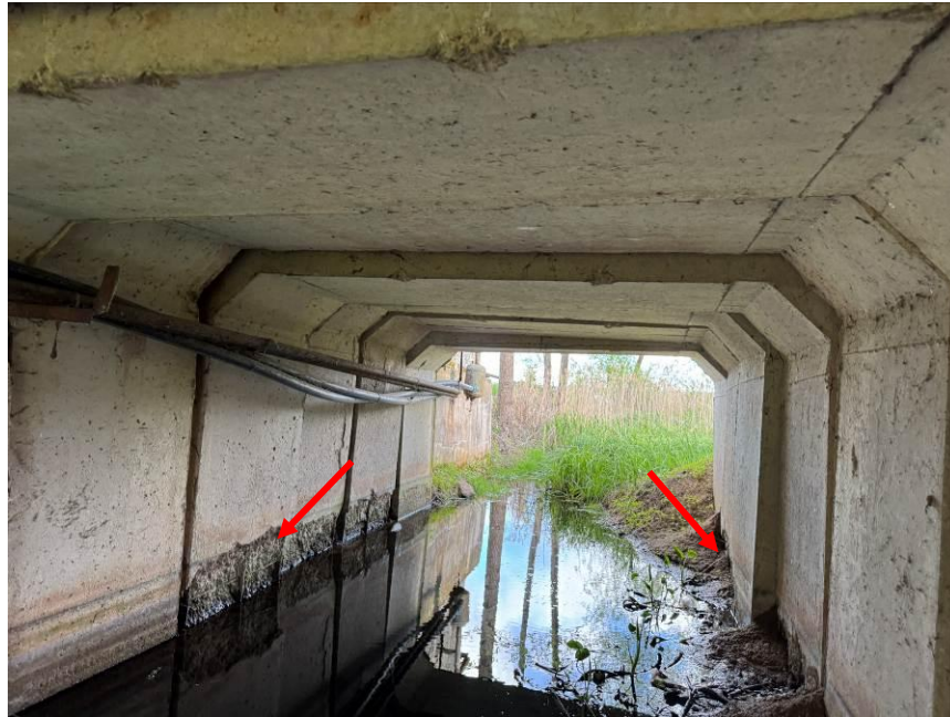
11.att. Nobīdījušies posmi, betona izdrupumi mainīgajā ŪL zonā, bojātas posmu saduršuves, tiek skalota uzbēruma smiltis. Skats caurtekas iekšpusē no ieteces puses.
