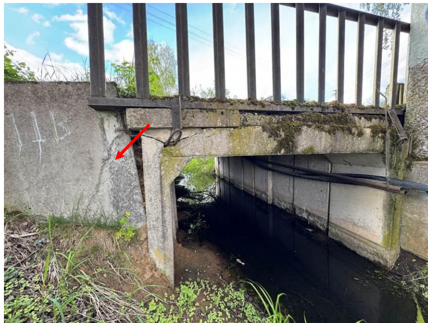
20.att. Nekvalitatīvs betons, nobīdījusies siena, ūdens caursūkšanās, izveidojies izskalojums. Skats uz sānu sienu pie krasta balsta Nr.2 lejtes pusē.
