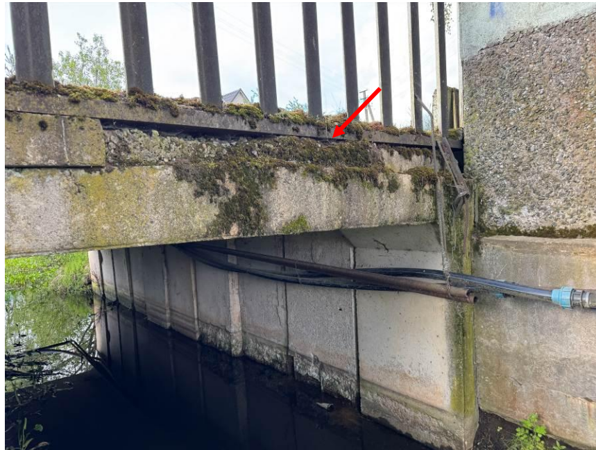
19.att. Nekvalitatīvs betons, betona izdrupumi, ūdens caursūkšanās. Skats uz gala sienu pie krasta balsta Nr.1 lejtes pusē.
