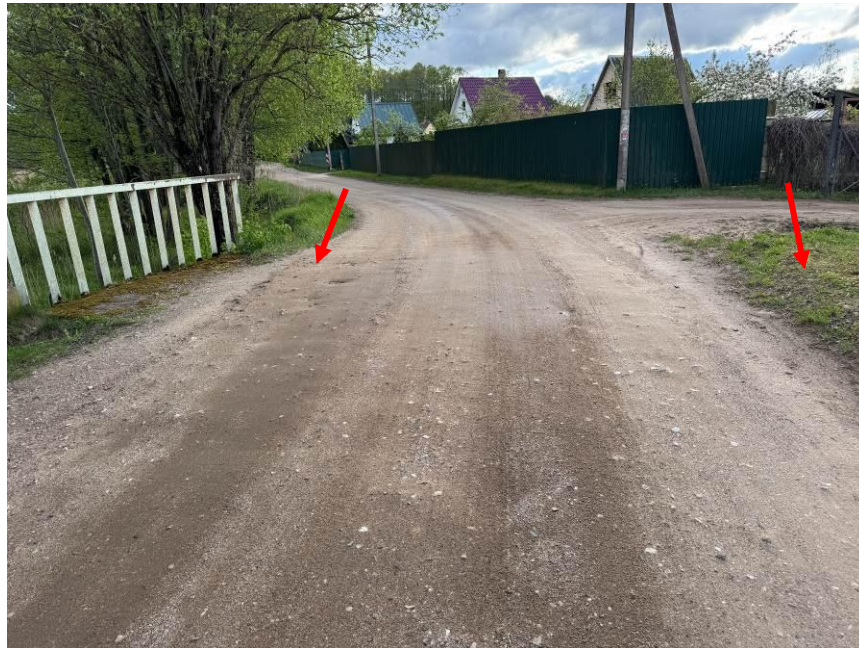
5.att. Veidojas bedres uz brauktuves malās apaugums. Skats virs caurtekas no krasta balsta Nr.2 (Dravnieku iela).
