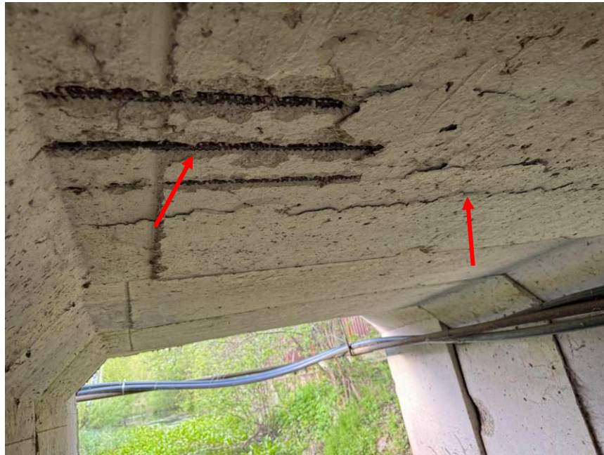
15.att. Drūp posma betons, korozijas plaisas atsegts korodē stiebrojums. Skats uz caurtekas posms griestiem vidū.
