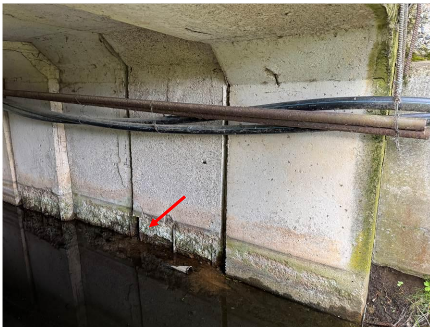
13.att. Nobīdījušies posmi, betona izdrupumi mainīgajā ŪL zonā, bojātas posmu saduršuves, tiek skalota uzbēruma smiltis. Skats caurtekas iekšpusē pie krasta balsta Nr.2 no izteces puses.
