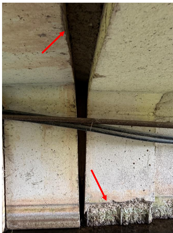
14.att. Bojātas caurteku posmu saduršuves, izdrupis materiāls. Mainīgajā ŪL zonā izdrupis caurtekas posma betons, korodē stiegrojums. Skats uz caurtekas posmiem pie krasta balsta Nr.1 vidū.
