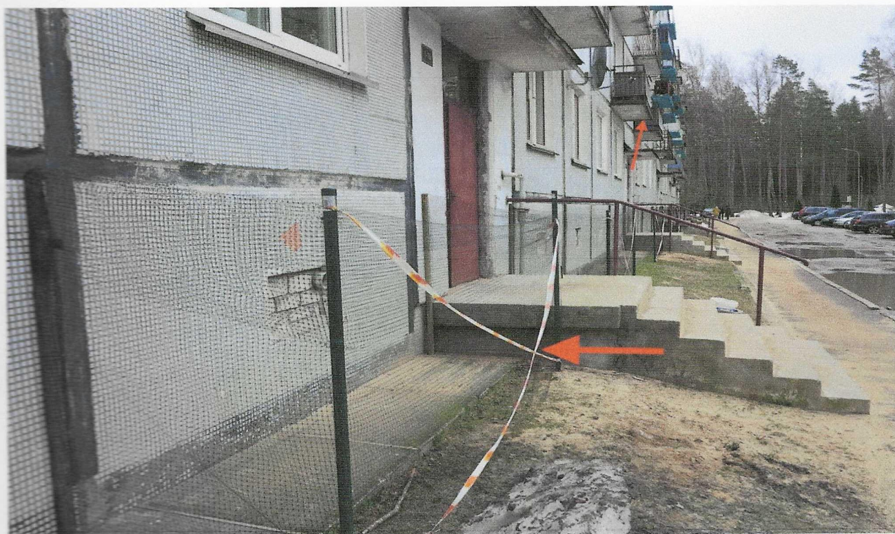
Fotofiksācija F-2. Balkonu plākšņu plaisas, metāla konstrukcijas korodējumi, nelikumīgās balkonu pārbūves, bīstamās zonas brīdinājuma lentas zem balkoniem un noklātie balkoni ar avārijas zaļo sietu.
