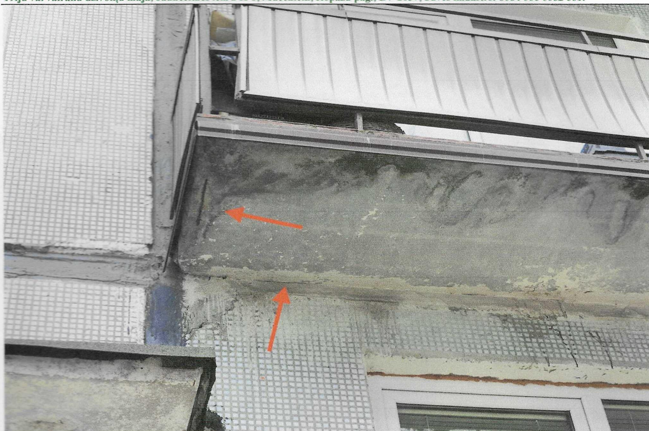
Fotofiksācija F-3. Balkonu plākšņu plaisas, metāla stiprinājumu un margu korodējumi.
