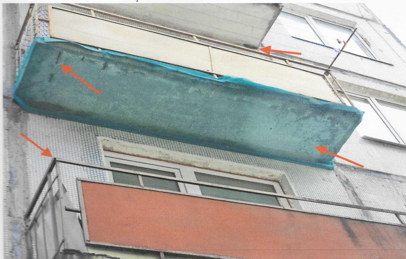
Fotofiksācija F-6. Balkonu plākšņu plaisas, metāla stiprinājumu, metāla margu korozija un betona atdalīšanās. Tamdēļ pašlaik ir ieklāts aizsargsiets 58 % balkoniem.
