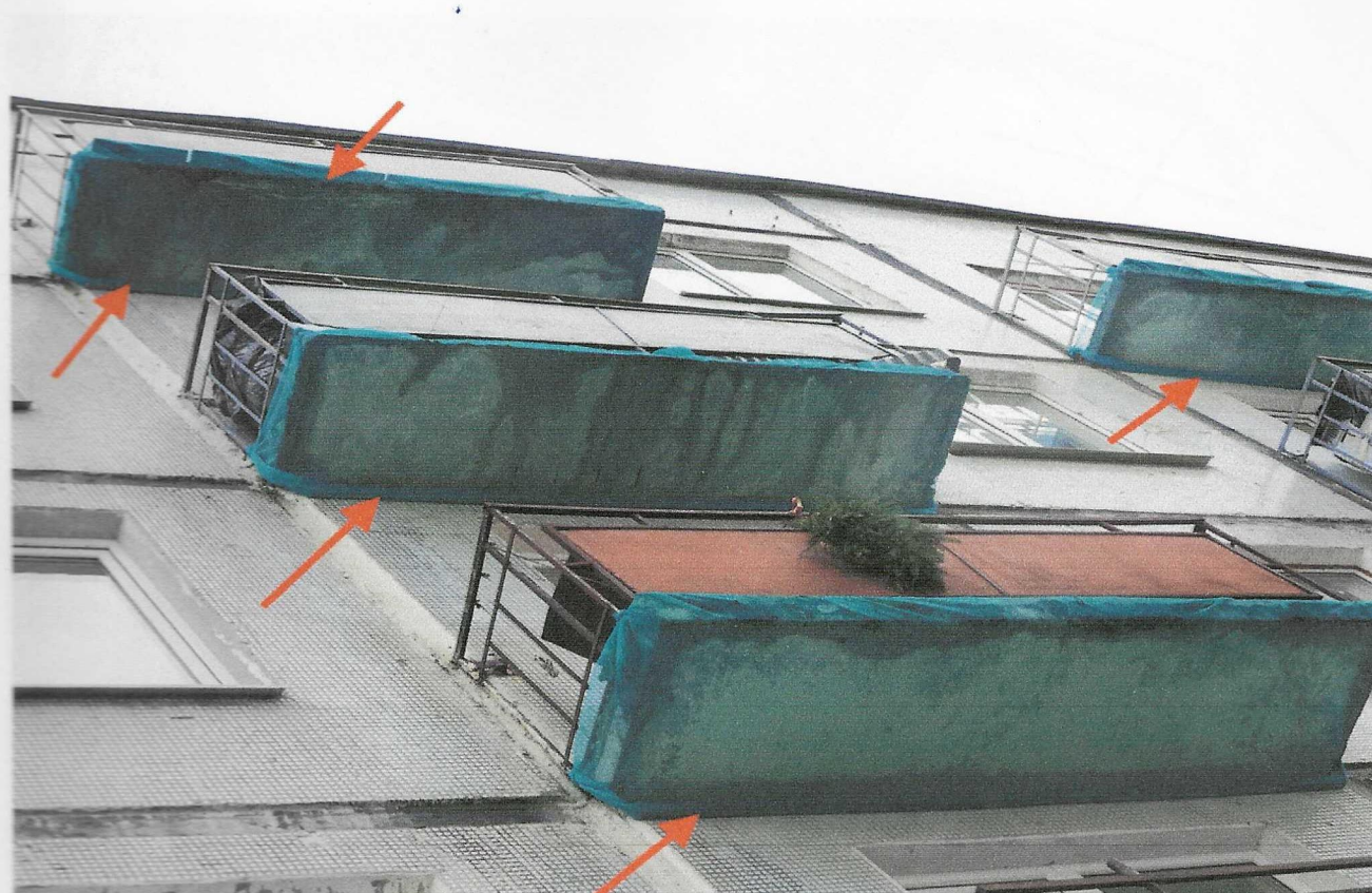
Fotofiksācija F-4. Balkonu plākšņu plaisas, metāla stiprinājumu, metāla margu korozija un betona atdalīšanās. Tamdēļ pašlaik ir ieklāts aizsargsiets 58 % balkoniem.
