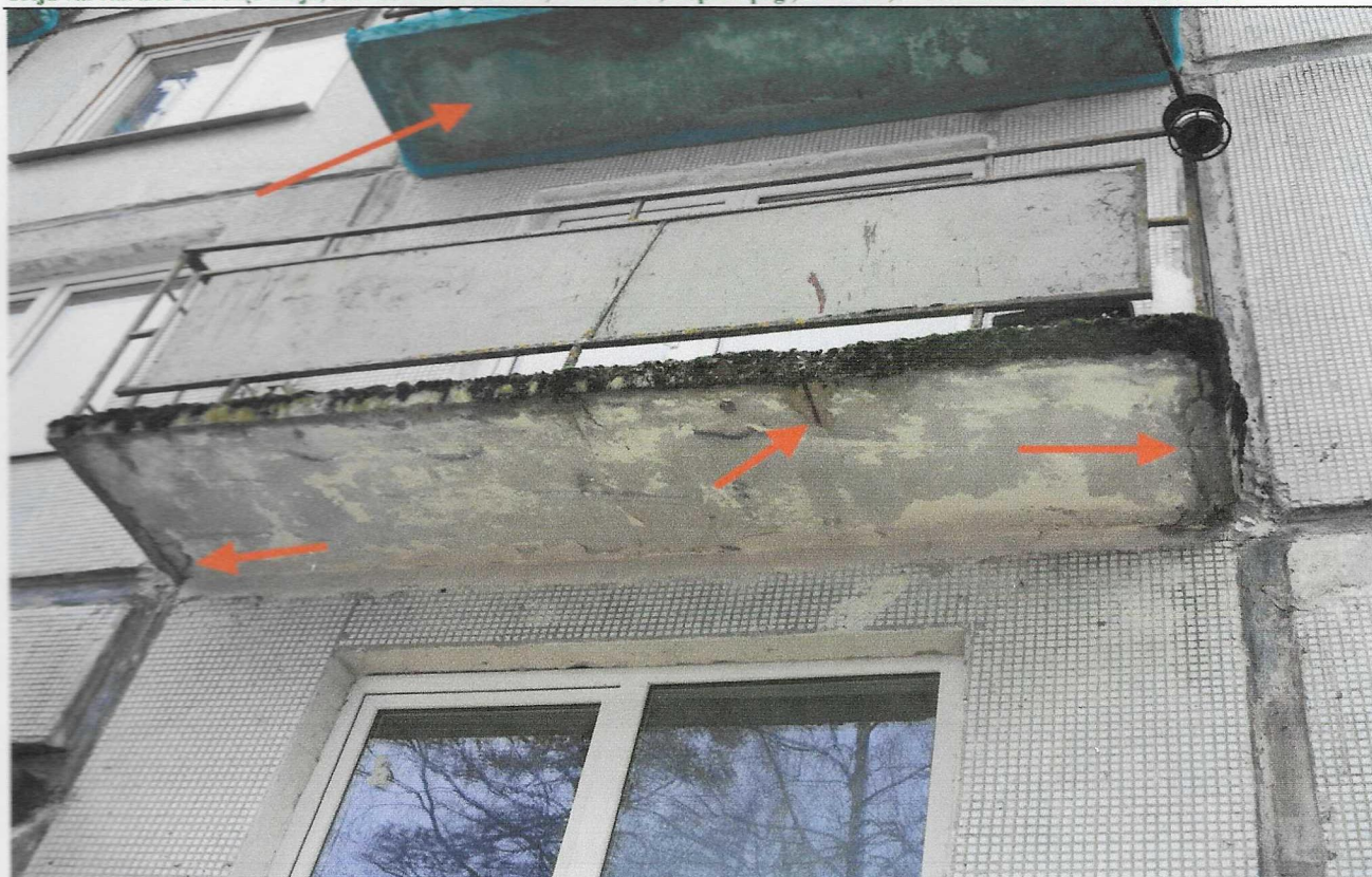
Fotofiksācija F-5. Balkonu plākšņu plaisas, metāla stiprinājumu korodējumi un metāla margu korozija.
